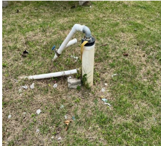
Figura 11. Pozo #1, equipamiento hidráulico
