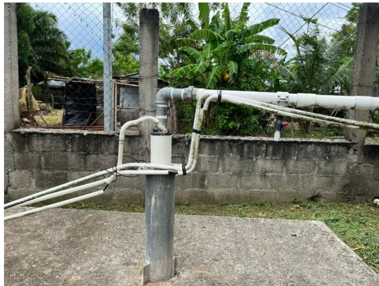
Figura 1. Sistema de bombeo, El Banano
