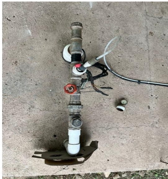
Figura 6. Pozo #2, Equipamiento hidráulico
