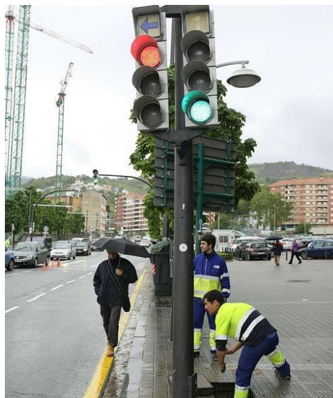
Ilustración 16. Semáforos en cascada
