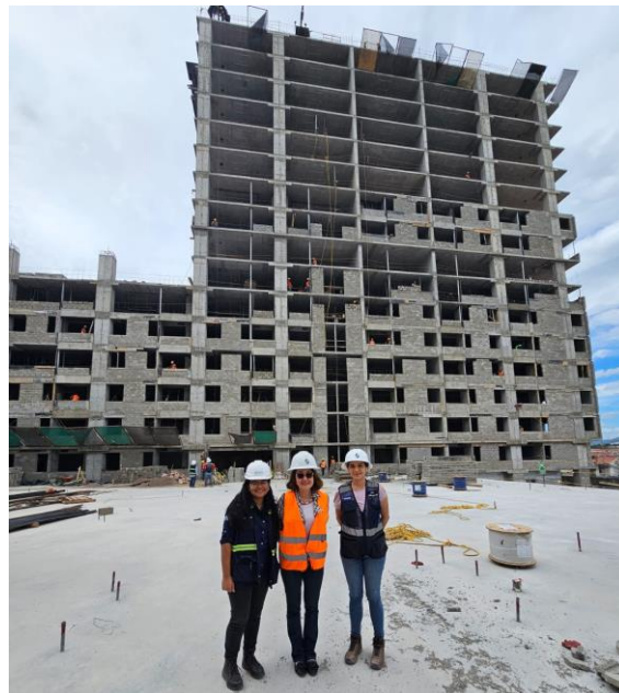
Ilustración 57. Visita de la Ing. Karla Uclés al proyecto junto al Ingeniero de Proyectos Francisco García e Ingeniero Residente Josselyn Morales
