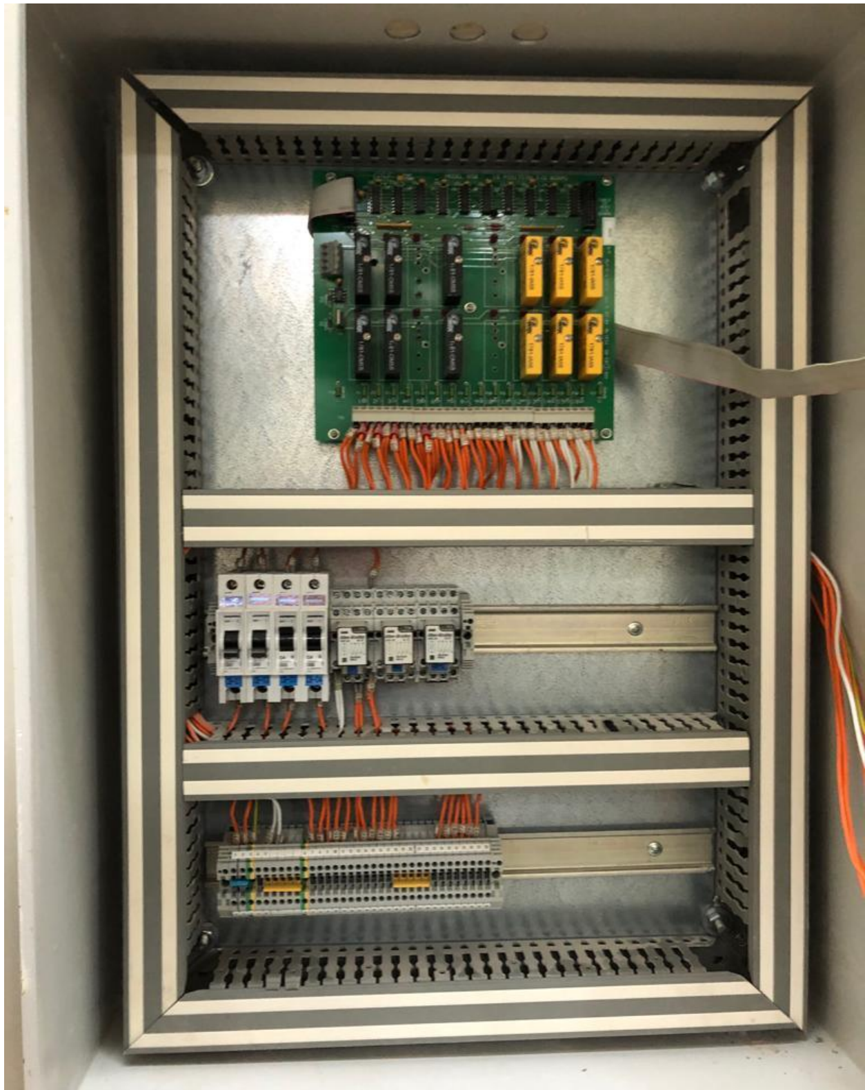
Ilustración 18 Centro de conexión controlador GSE
