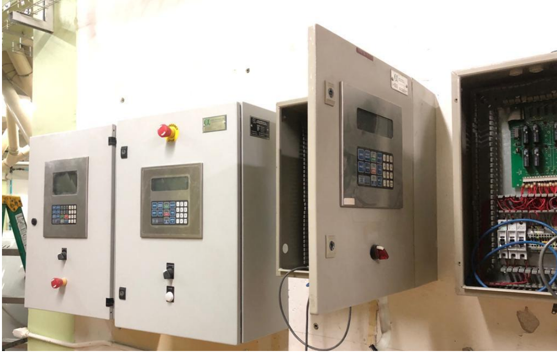
Ilustración 19 Centro de controladores GSE
