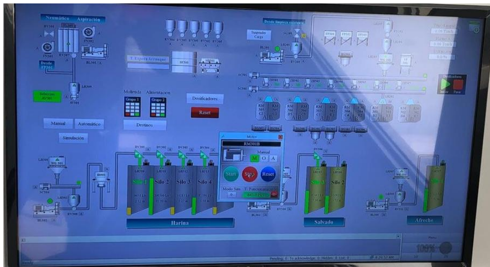
Ilustración 13. Scada Molino 5 y Anexo
