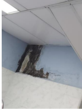
Ilustración 41. Crecimiento de hongos en pared de Hospitalización de Cirugía
