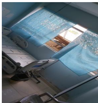
Ilustración 24. Ventilación natural en Hospitalización de Cirugía
