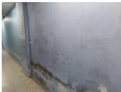
Ilustración 43. Crecimiento de hongos en pared de Emergencia Ortopédica
