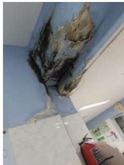
Ilustración 42. Crecimiento de hongos en pared de Emergencia Pediatría
