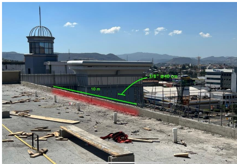
Ilustración 22- Pretil perimetral en la edificación anexo a complejo IPM
