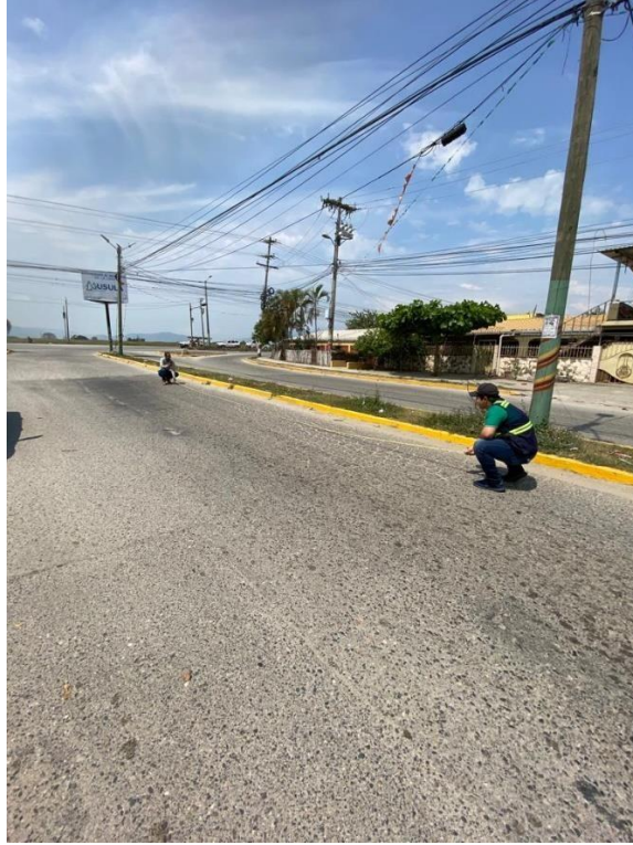
Ilustración 140-Medición de fallas presentes en el asfalto
