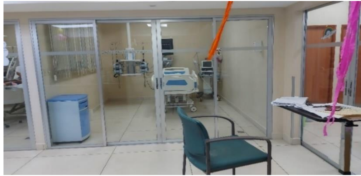
Ilustración 68 - Vista externa de cubículo (entorno real).
