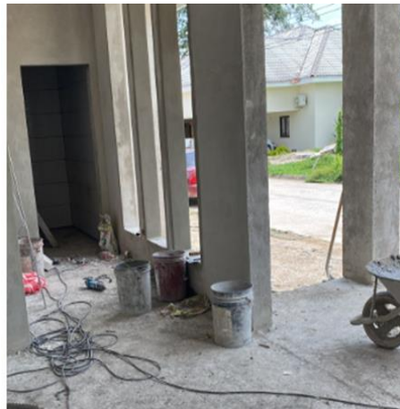
Ilustración 48 - Área de paredes pulidas
