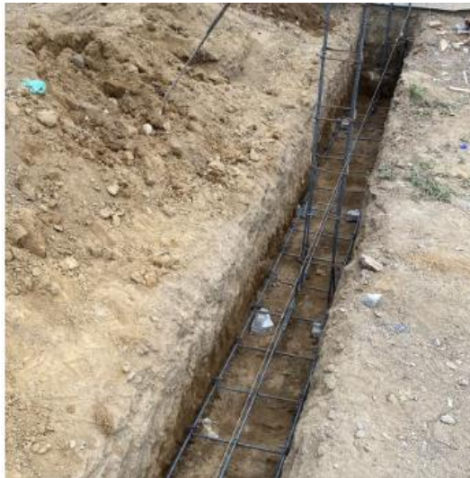
Ilustración 51 - Armado de zapata corrida de 0.20mx0.40m con 3 varillas de 3/8" y anillos @0.15m de 3/8"
