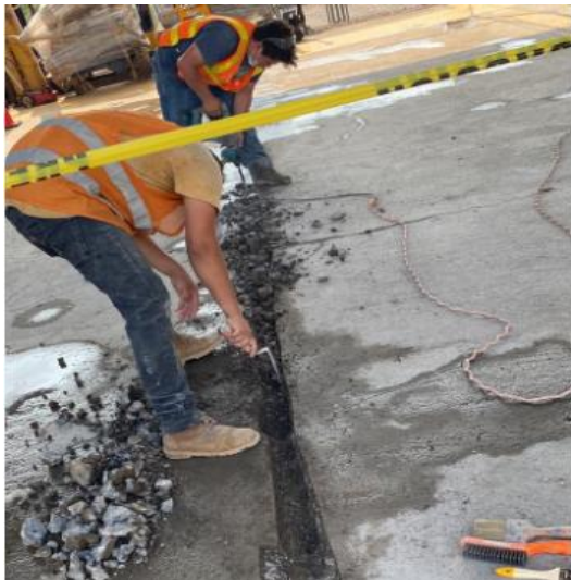
Ilustración 53 - Reparación de despostillamiento a lo largo de las juntas (Remoción de escombros y rompedura con rotamartillo)
