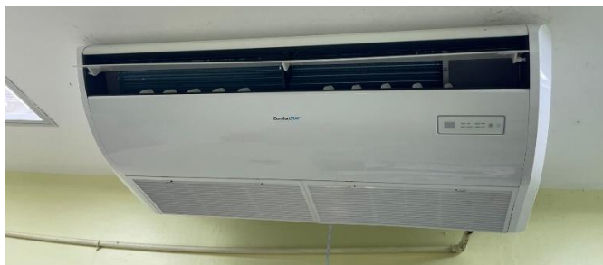
Ilustración 28. Mini-Split con capacidad de 36,000 BTU/h en quirófanos.
