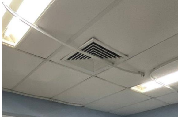
Ilustración 29. Red central de aire acondicionado
