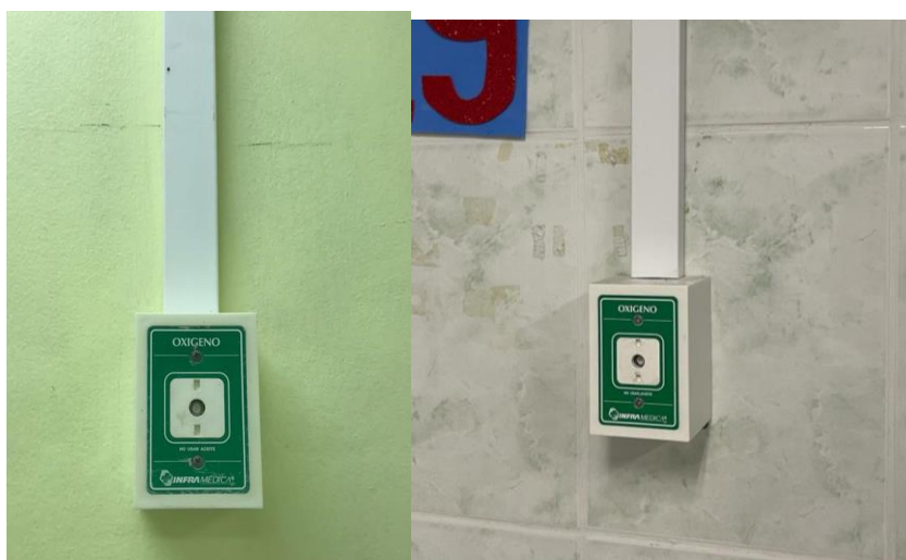
Ilustración 52. Toma de pared tipo OHMEDA
