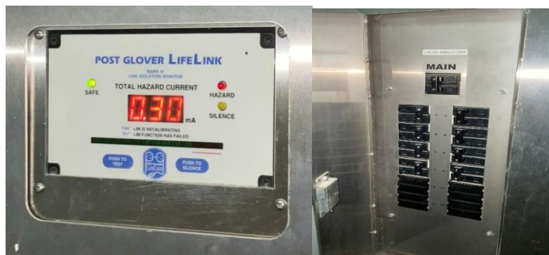
Ilustración 45. Paneles de aislamiento eléctrico.
