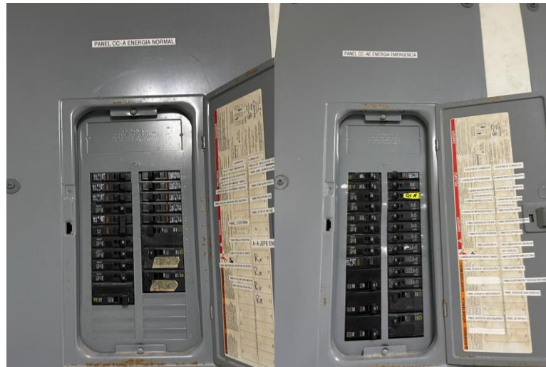
Ilustración 44. Paneles de distribución en Sala de Operaciones.
