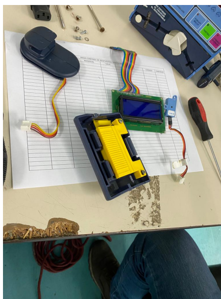
Ilustración 11 Repuestos reemplazados en una bomba ST 1000 SET
