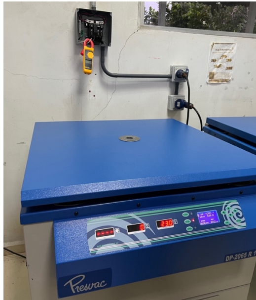
Ilustración 10: Instalación Eléctrica de Centrifuga
