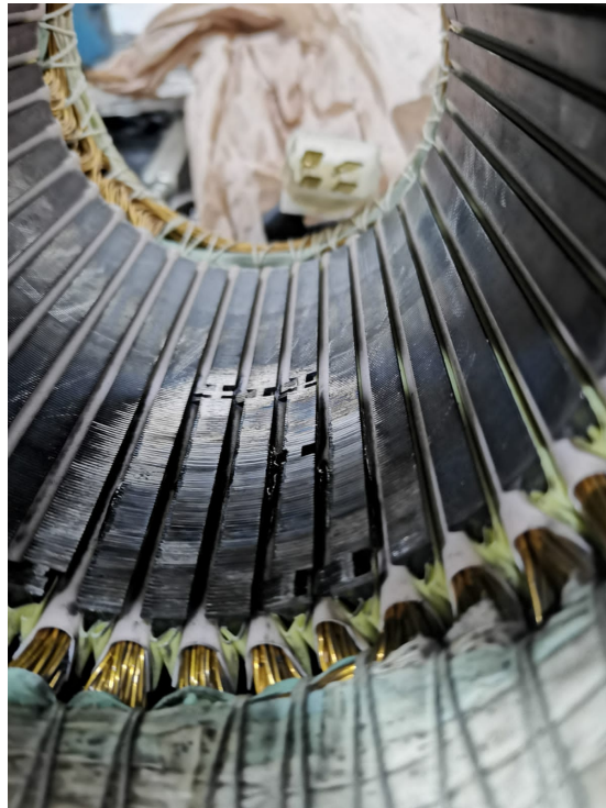
Ilustración 13: Daños a motor de equipo en prueba de funcionamiento
