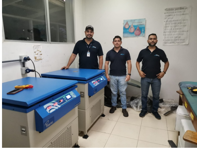
Ilustración 11: Servicio Técnico con máquinas instaladas
