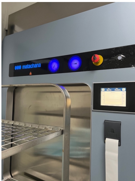
Ilustración 18: Verificación de funcionamiento de esterilizador marca Matachana
