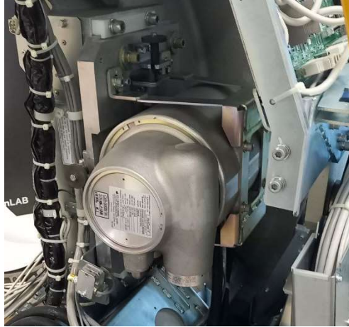
Ilustración 27 Tubo de Rayos X en mal estado.
