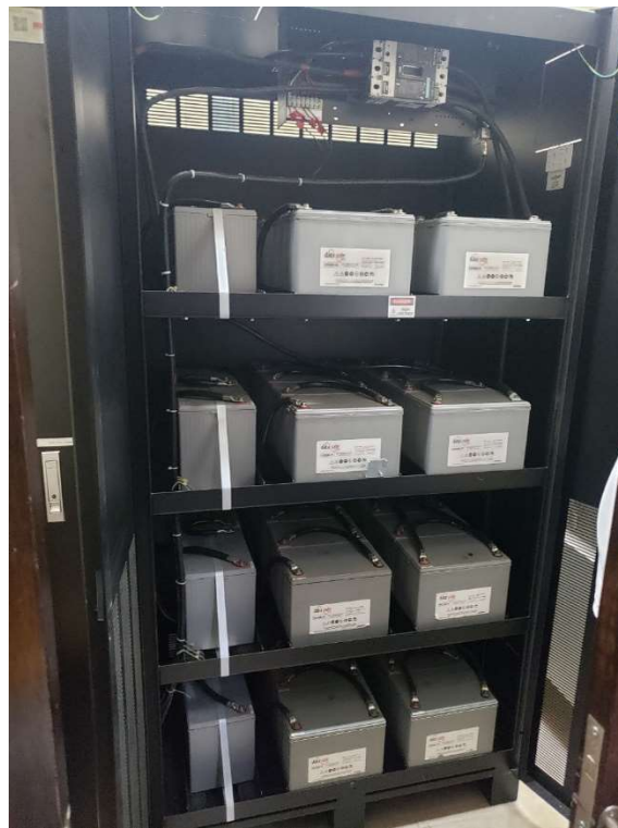
Ilustración 51 Banco de baterías para sistema de respaldo de TAC.
