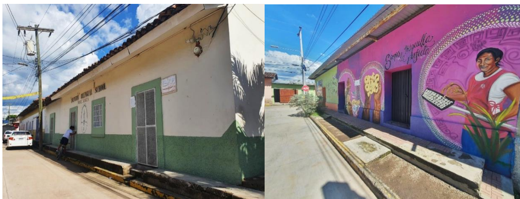
Ilustración 76. Estado actual de las aceras. Fuente: Yousseff Yuja
