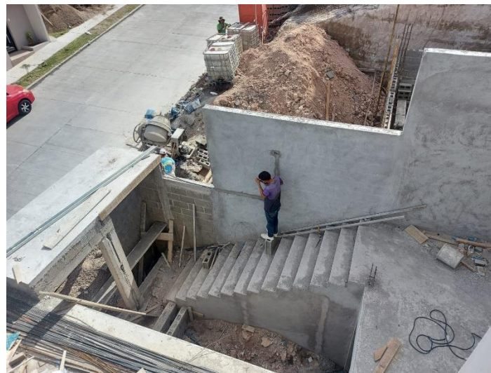
Ilustración 103 Repello en vivienda Villa los Naranjos, lote # 10
