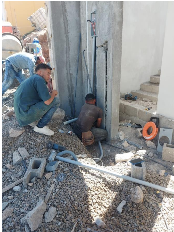
Ilustración 112 Medición de acometida
