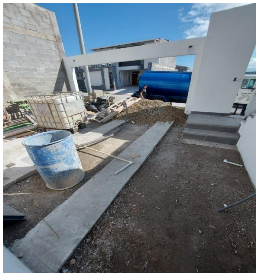
Ilustración 69 Llenado de cisterna de 3,500 galones
