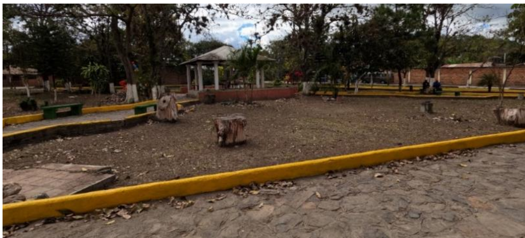
Ilustración 3. Estado actual del parque.
