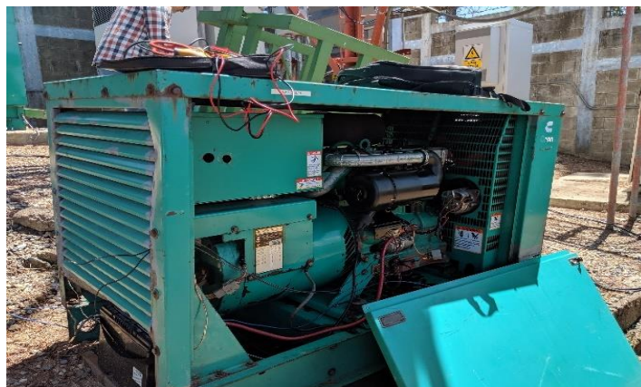
Ilustración 21: Generador en Quimistán
