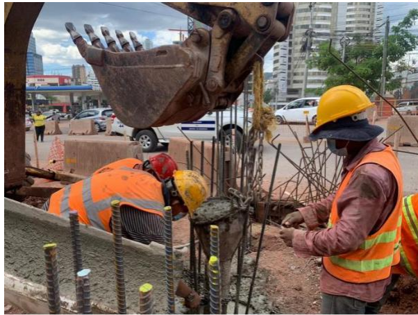
Ilustración 65 Fundición de 7 pilotes en el túnel CCIT-Hondutel en el sector de INGEOMIN
