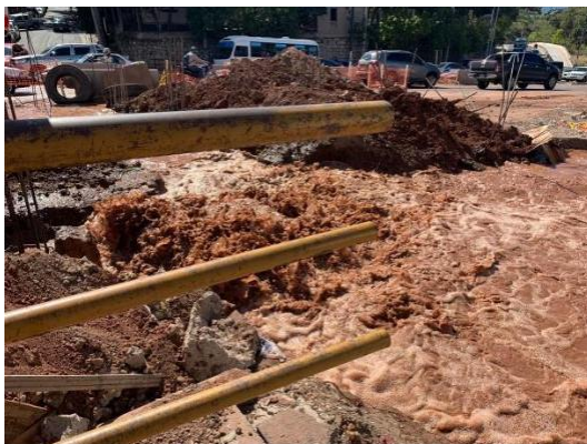
Ilustración 29 Fuga de tubería de agua potable en túnel CCIT-Hondutel
