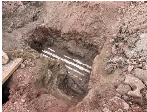
Ilustración 22 Descubrimiento de tubería PVC para fibra óptica de Hondutel
