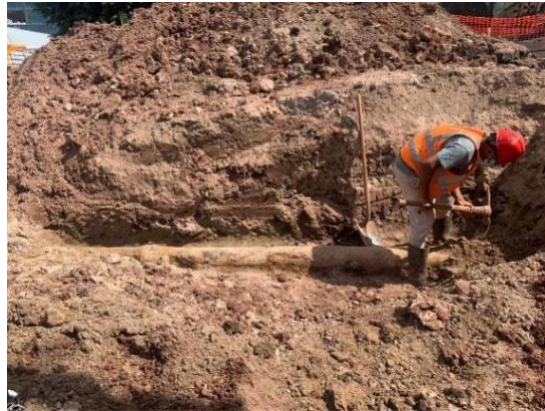
Ilustración 40 Descubrimiento de tubería de 8" en túnel CCIT-Hondutel
