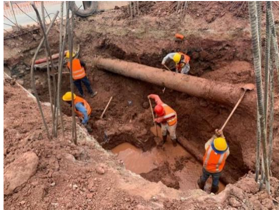
Ilustración 42 Excavación estructural para descubrimiento de tuberías de agua potable en túnel CCIT-Hondutel
