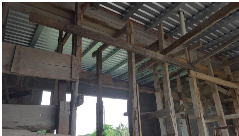
ILUSTRACIÓN 37 DETALLE DE LÁMINA PARA LOSA DE TECHO CON BAJADA DE AGUAS LLUVIAS
