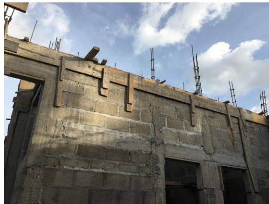
ILUSTRACIÓN 27 SOLERAS DE CIERRE DORMITORIO 1
