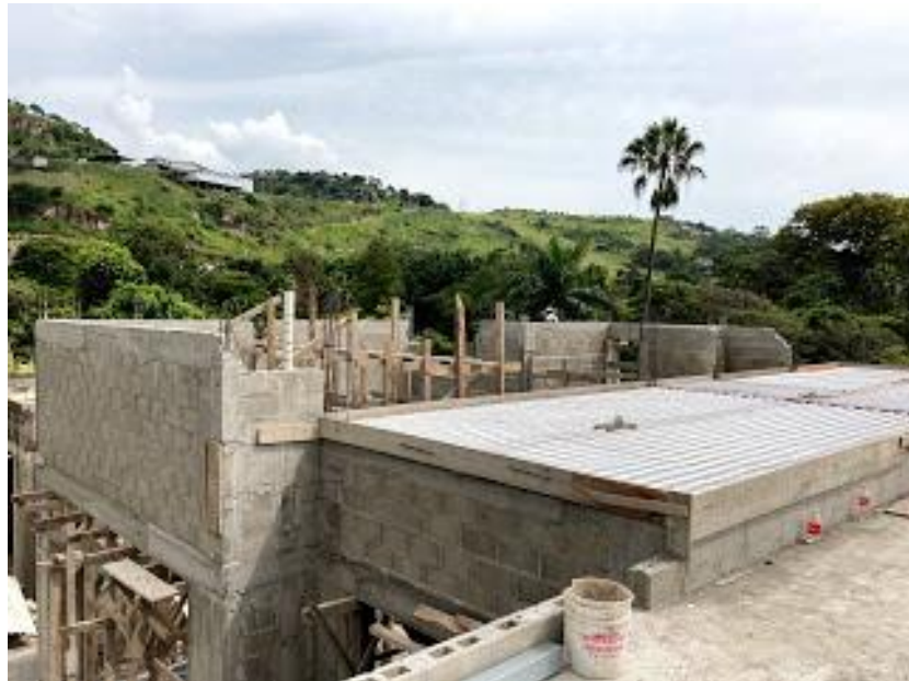
ILUSTRACIÓN 54 INSTALACIÓN DE ELECTROMALLA PARA LOSA DE TECHO E INSTALACIÓN DE DRENAJE PLUVIAL
