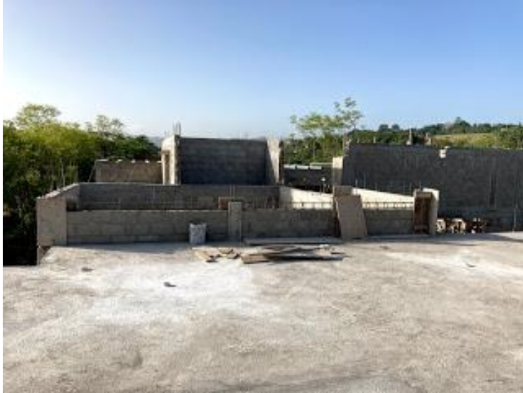
ILUSTRACIÓN 48 LEVANTAMIENTO DE BLOQUE HASTA NIVEL DE SOLERA DE CIERRE
