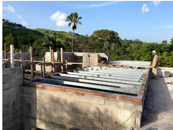
ILUSTRACIÓN 50 COLOCACIÓN Y ENTABICADO DE TUBOS DE 4X4 PARA LOSA DE MÓDULO DE COMEDOR
