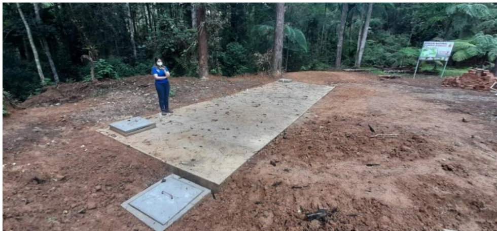
Ilustración 37 Fosa séptica en Panacu, Cortés
