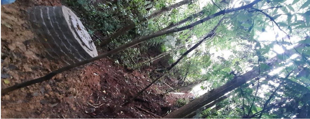
Ilustración 38 Pozo de inspección hacia fosa séptica
