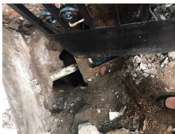
Ilustración 46 Alcantarillado del SANAA
