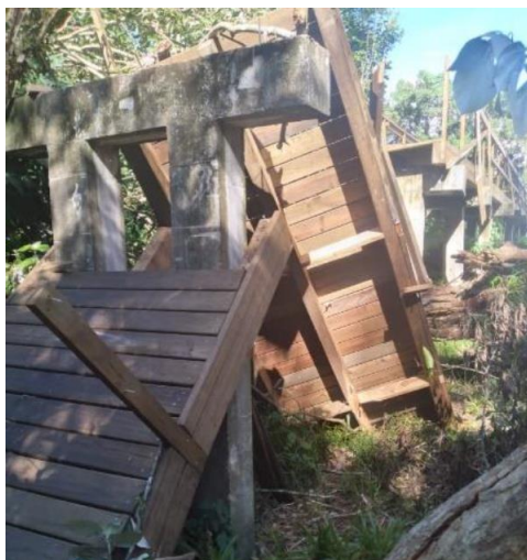
Ilustración 17 Puente de polines derribado por un árbol en Parque Los Naranjos
