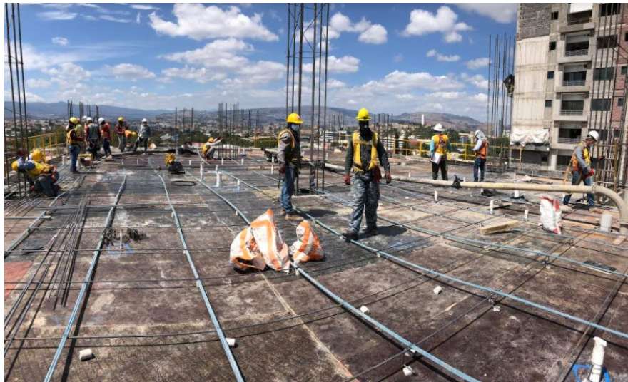
Ilustración 54-Colado de elementos estructurales de losa N-07 y avance en tarima de losa N-08
