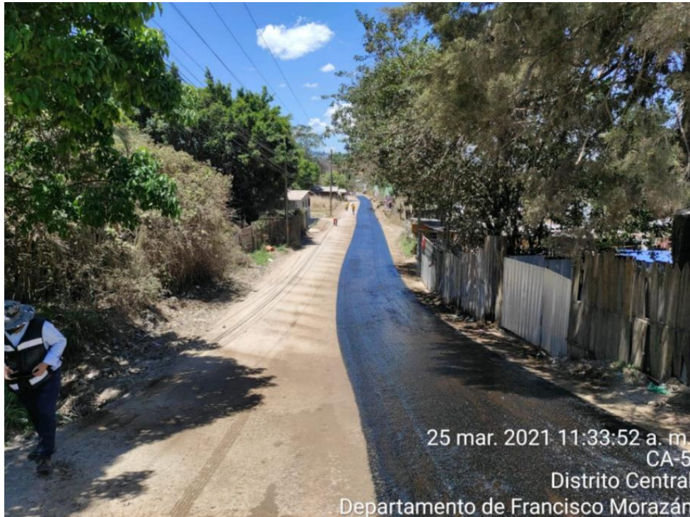
Ilustración 60. Imprimación de emulsión asfáltica sobre tramo, desde la est.1+705 hasta la est.1+890
