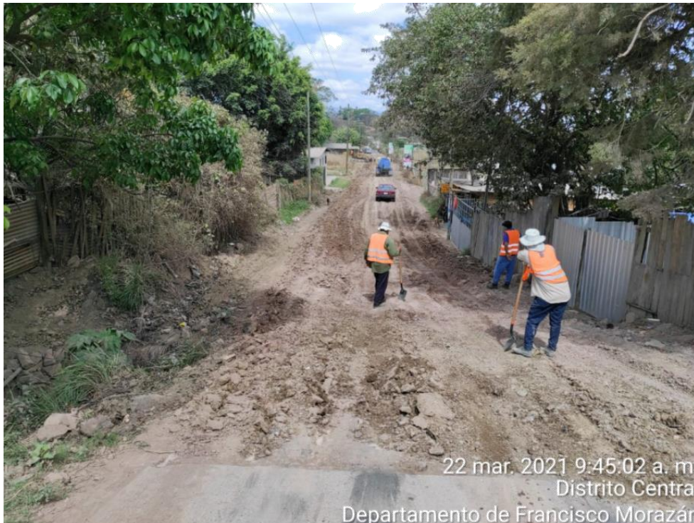
Ilustración 56. Escarificación de tramo a ser estabilizado con el 3% de cemento, desde la estación 1+710 hasta la estación 1+890
