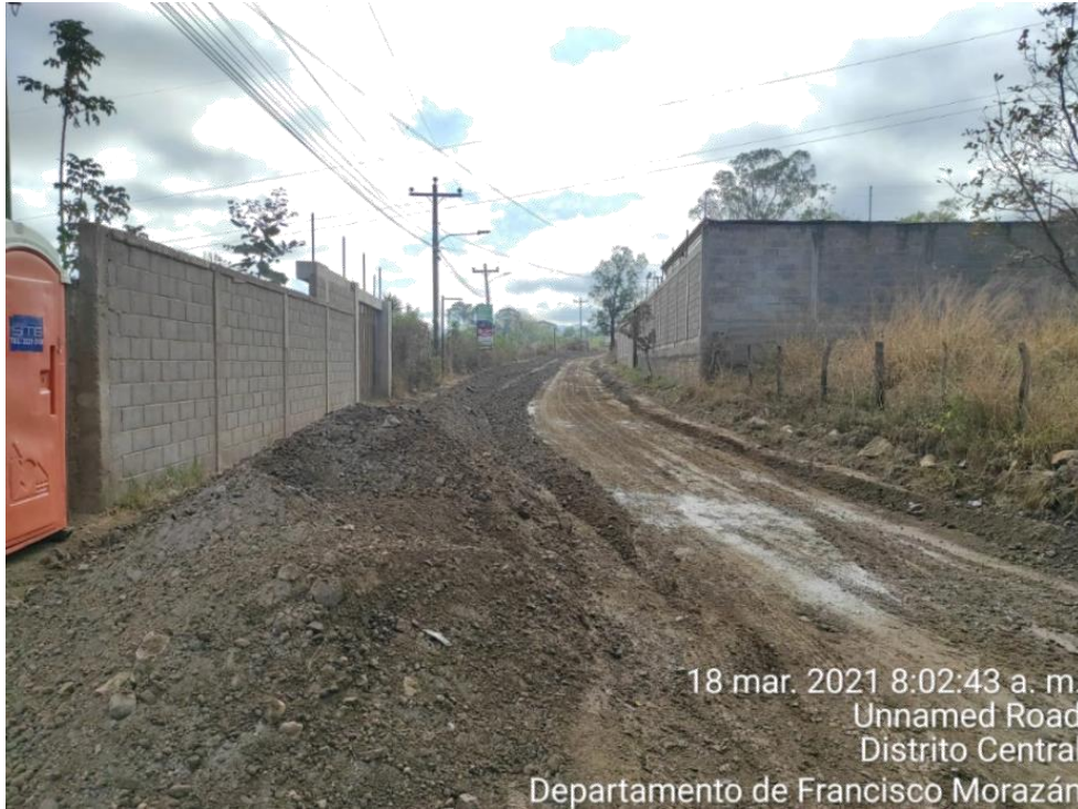
Ilustración 54. Estabilización de tramo con el 3% de cemento, cuyo tramo ya había sido mezclado en seco el día anterior desde la estación 1+550 a estación 1+710
