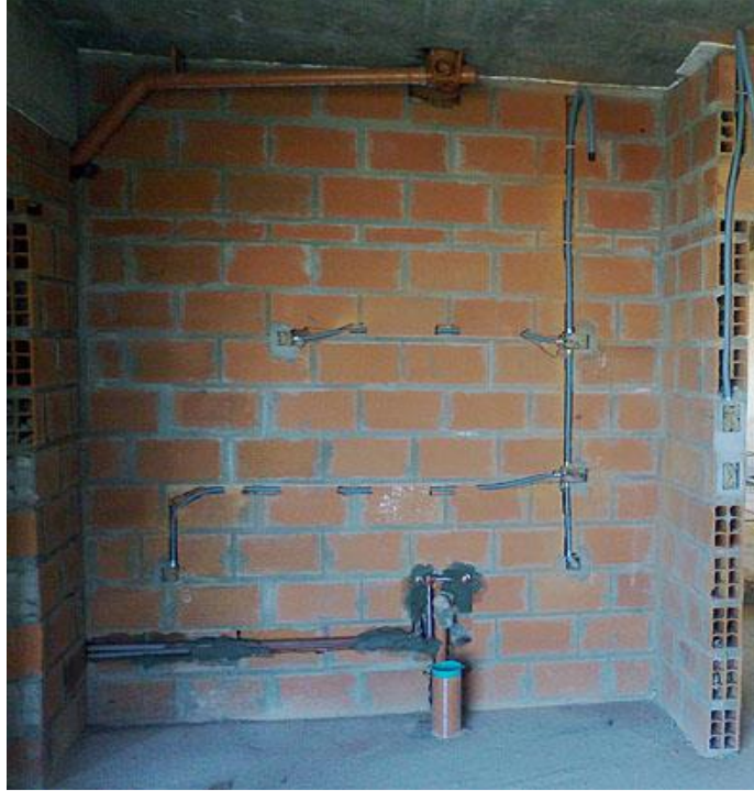
Ilustración 25-Instalación eléctrica en vivienda
