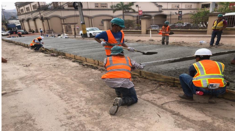
Ilustración 62 Pavimento MR-650 Est. 0+168 – 0+234
