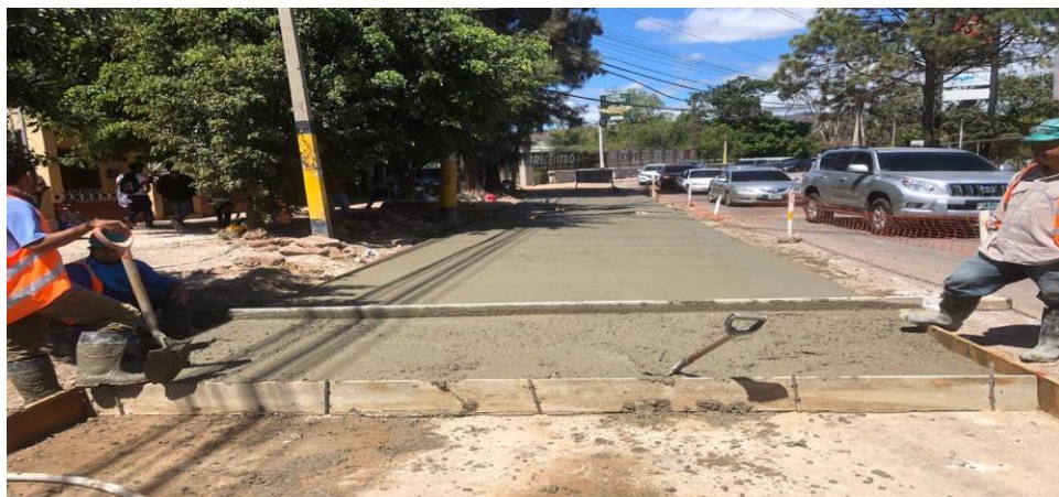
Ilustración 66 Pavimento MR-650 Est. 0+020- 0+050
