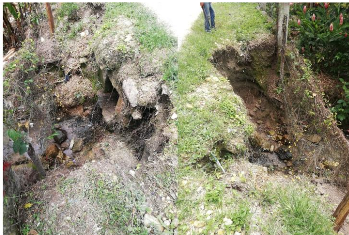
Ilustración 32: Desprendimiento de suelo en ubicación del colector principal
