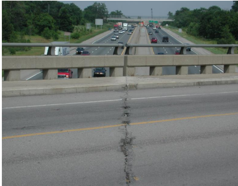
Ilustración 17 Puente de Grove Street previo a rehabilitación de la estructura
