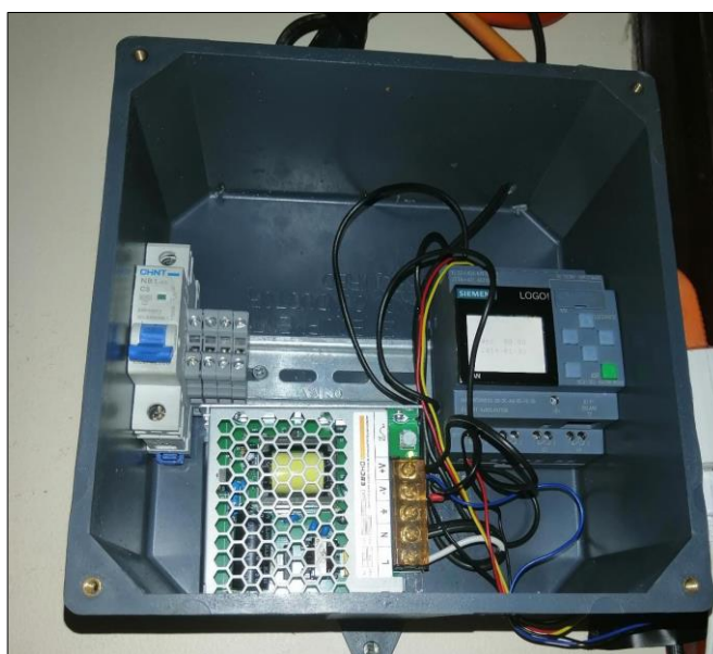
Figura 8.27 Panel de control (Elaboración propia, 2021)
