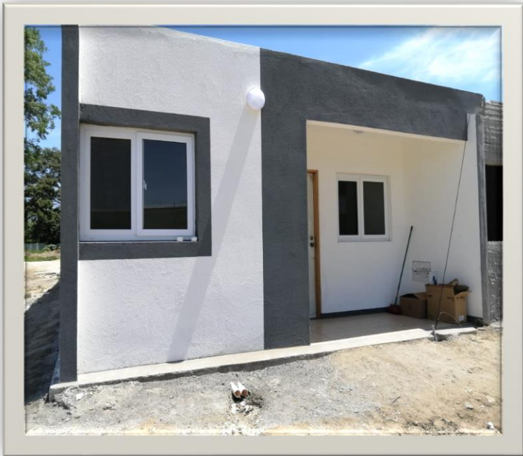
Condominio de ZEDE Morazán, ubicado en el Área Residencial de la ZEDE, esta área se encuentra aún en construcción. Su costo por arrendamiento mensual será de L.2,000.00
