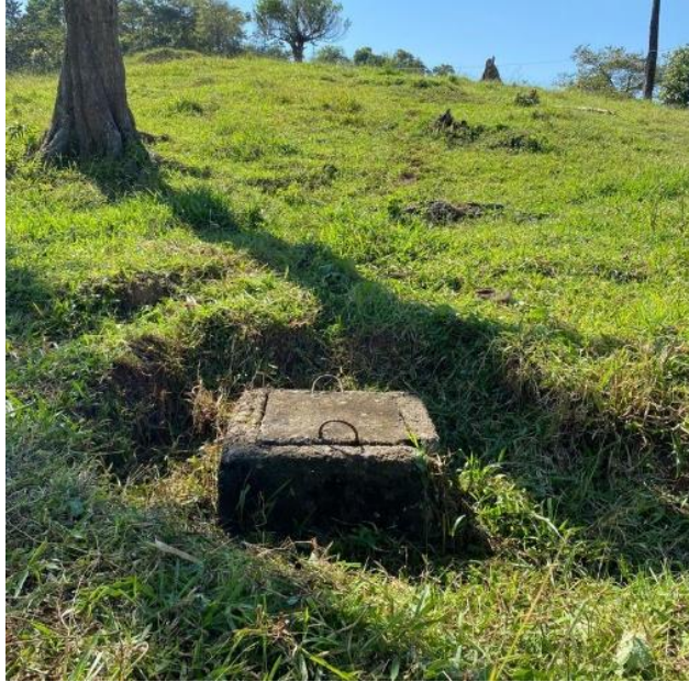
Ilustración 24-Estación reductora de presión #3
