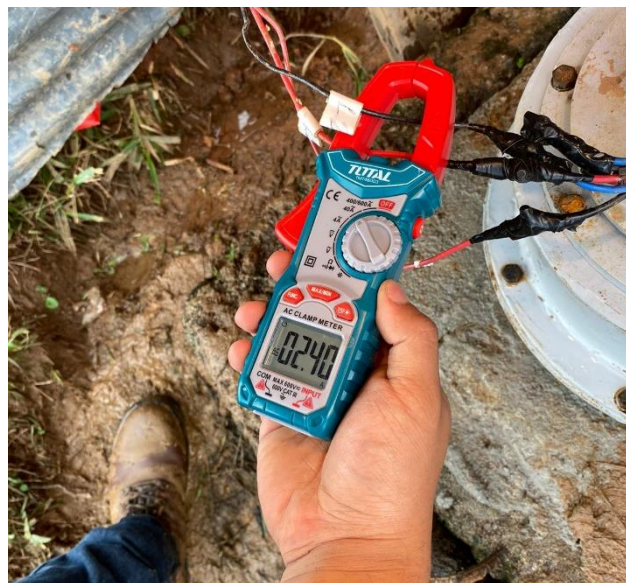
Ilustración 58: Medición de la corriente máxima entregada por el generador eléctrico
