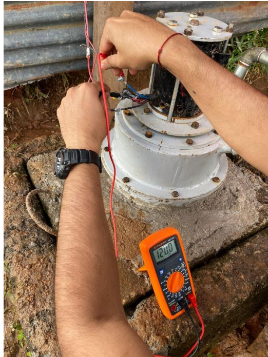
Ilustración 57: Medición del voltaje del generador
