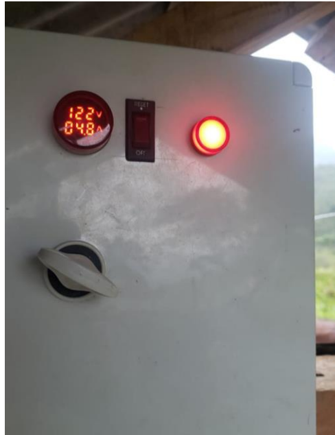
Ilustración 59: Parte frontal de la caja de control de la micro central
