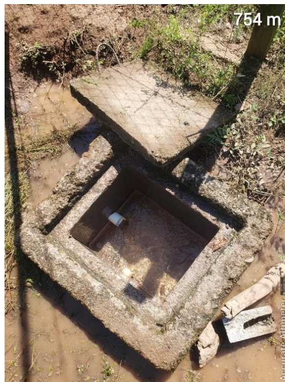
Ilustración 40-Altura de la estación reductora de presión #2
