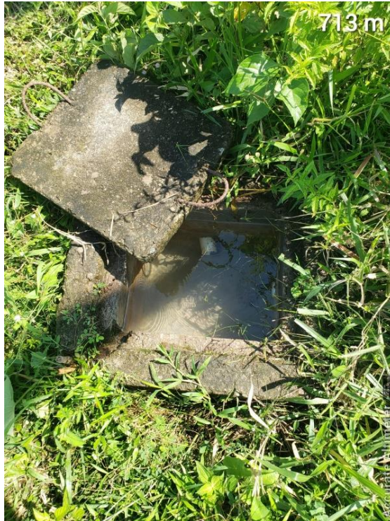
Ilustración 41-Altura de la estación reductora de presión #3
