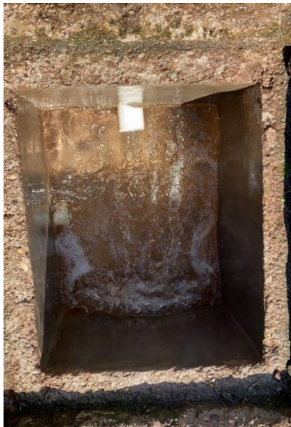
Ilustración 25-Estación reductora de presión #2
