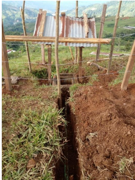
Ilustración 51: Excavación de la tubería en la estación reductora de presión, techado y cercado de la zona de instalación
