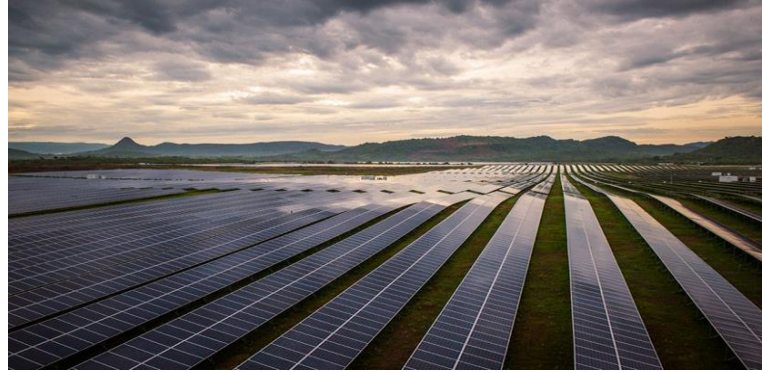
Ilustración 15. Sistema Solar Fotovoltaico sobre terreno
