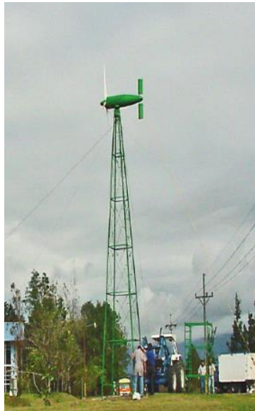
Ilustración 7: Pequeño aerogenerador instalado en el TEC
