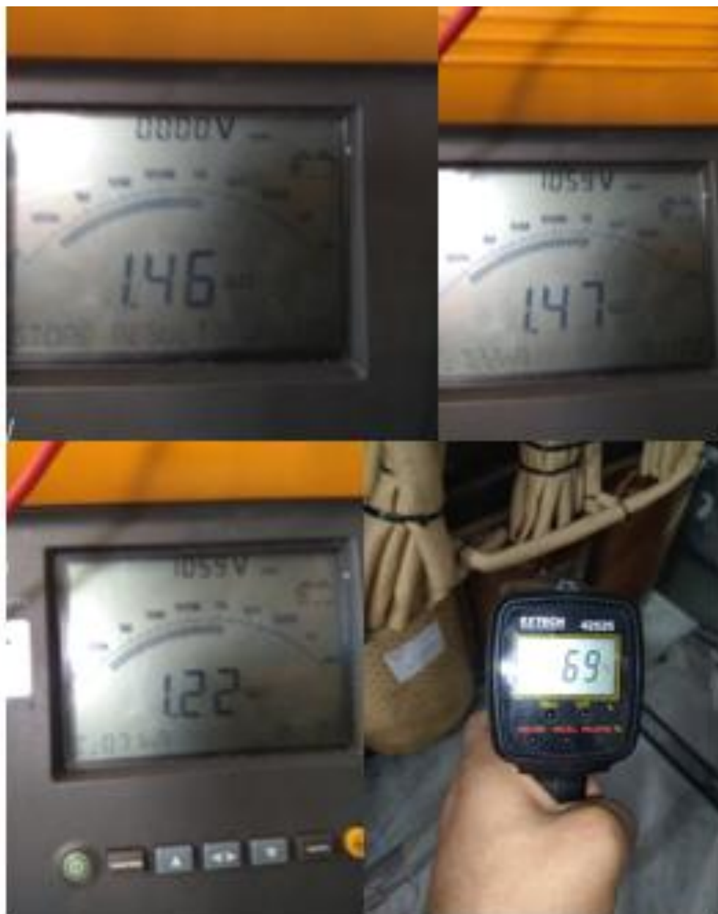
Ilustración 55: Prueba de Resistencia de Aislamiento 3247-1
