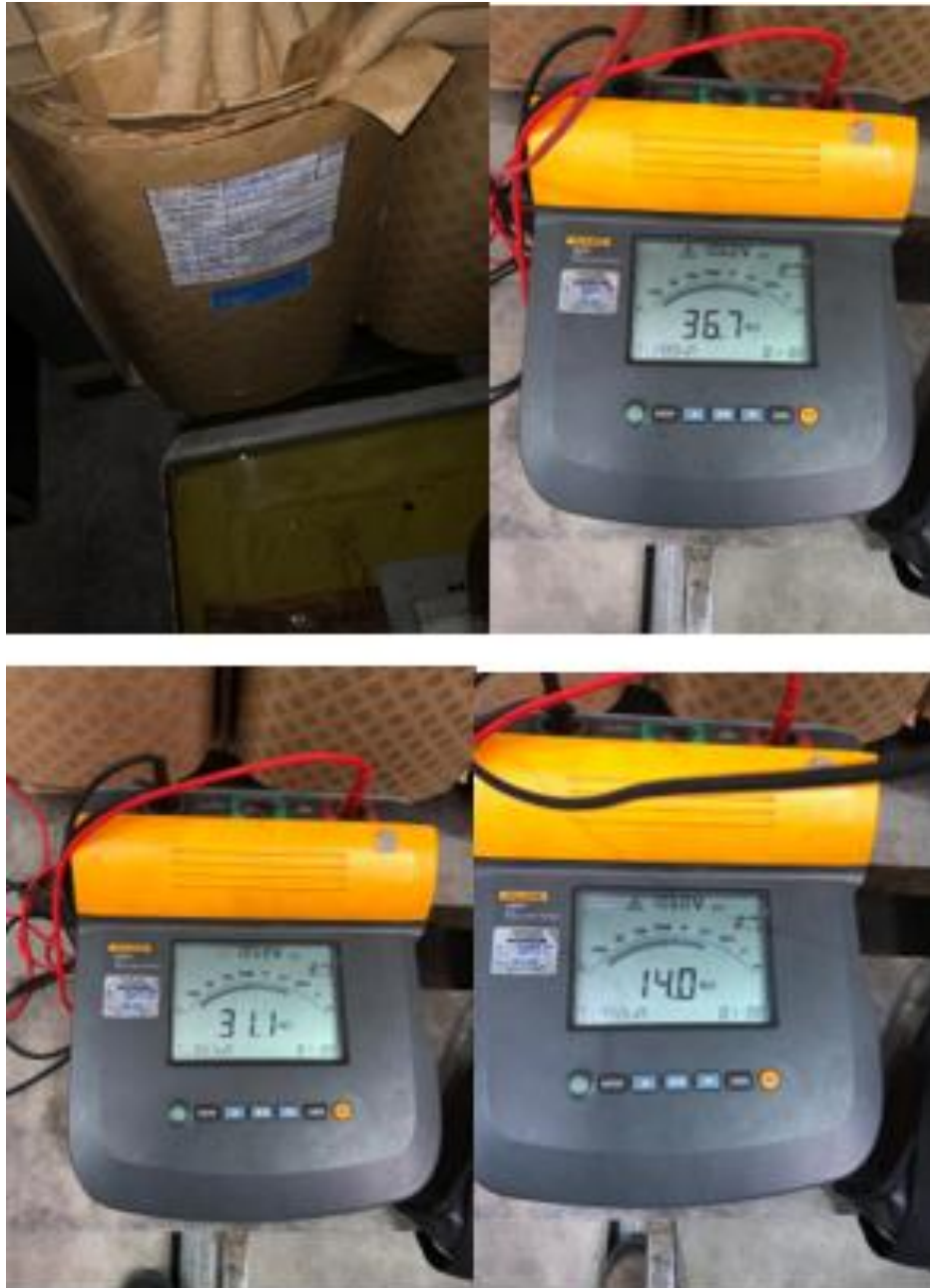
Ilustración 45: Prueba de Resistencia de Aislamiento 3503-3
