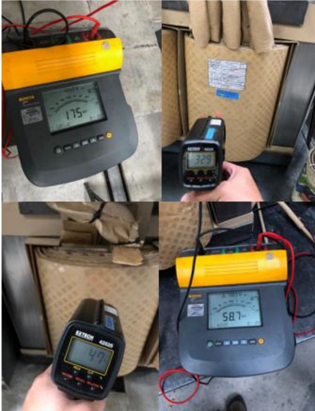
Ilustración 44: Prueba de Resistencia de Aislamiento 3542-1
