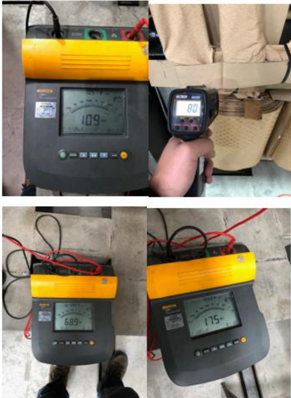
Ilustración 43: Prueba de Resistencia de Aislamiento 3542-1
