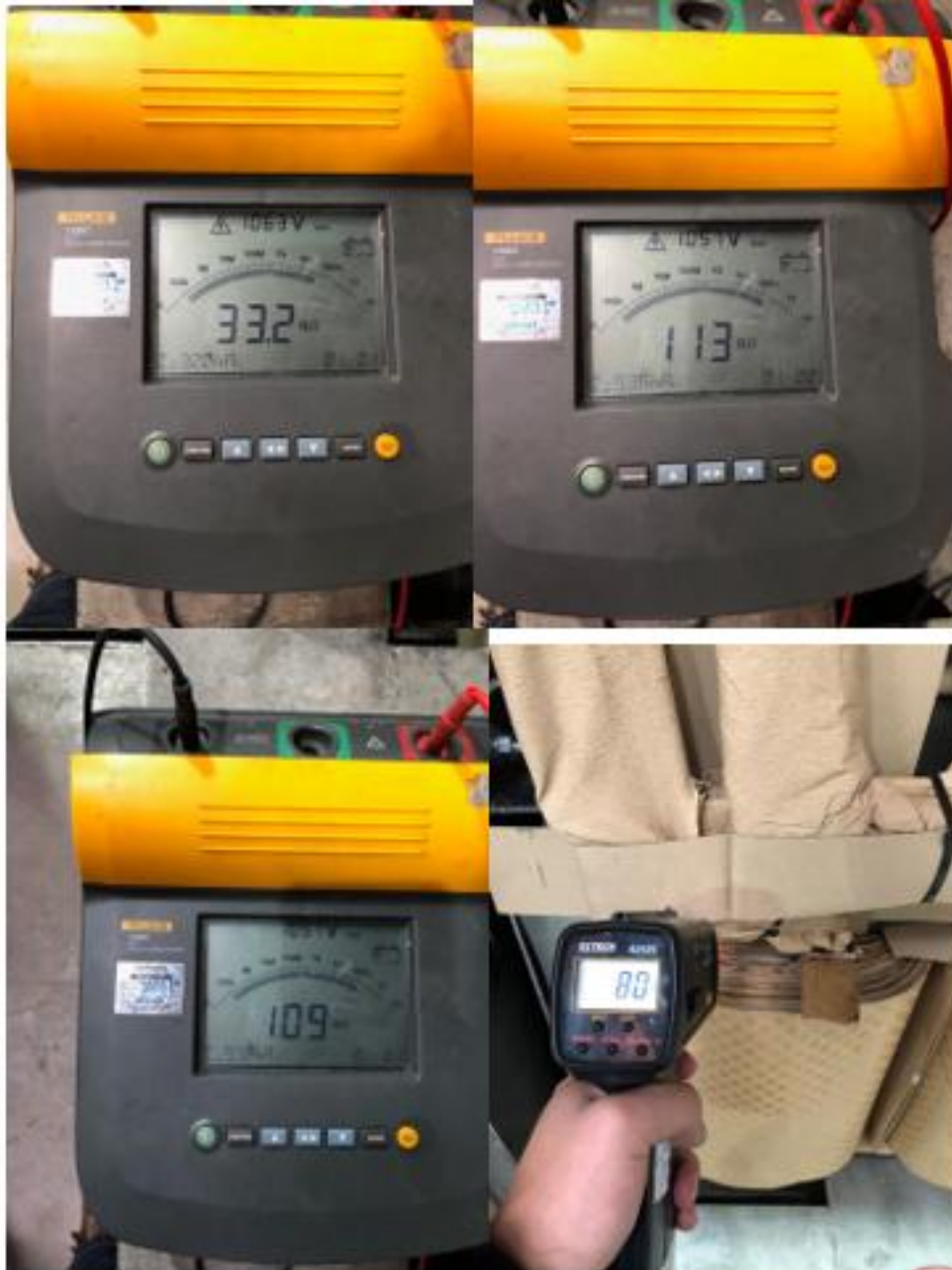
Ilustración 40: Prueba de Resistencia de Aislamiento 3542-1
