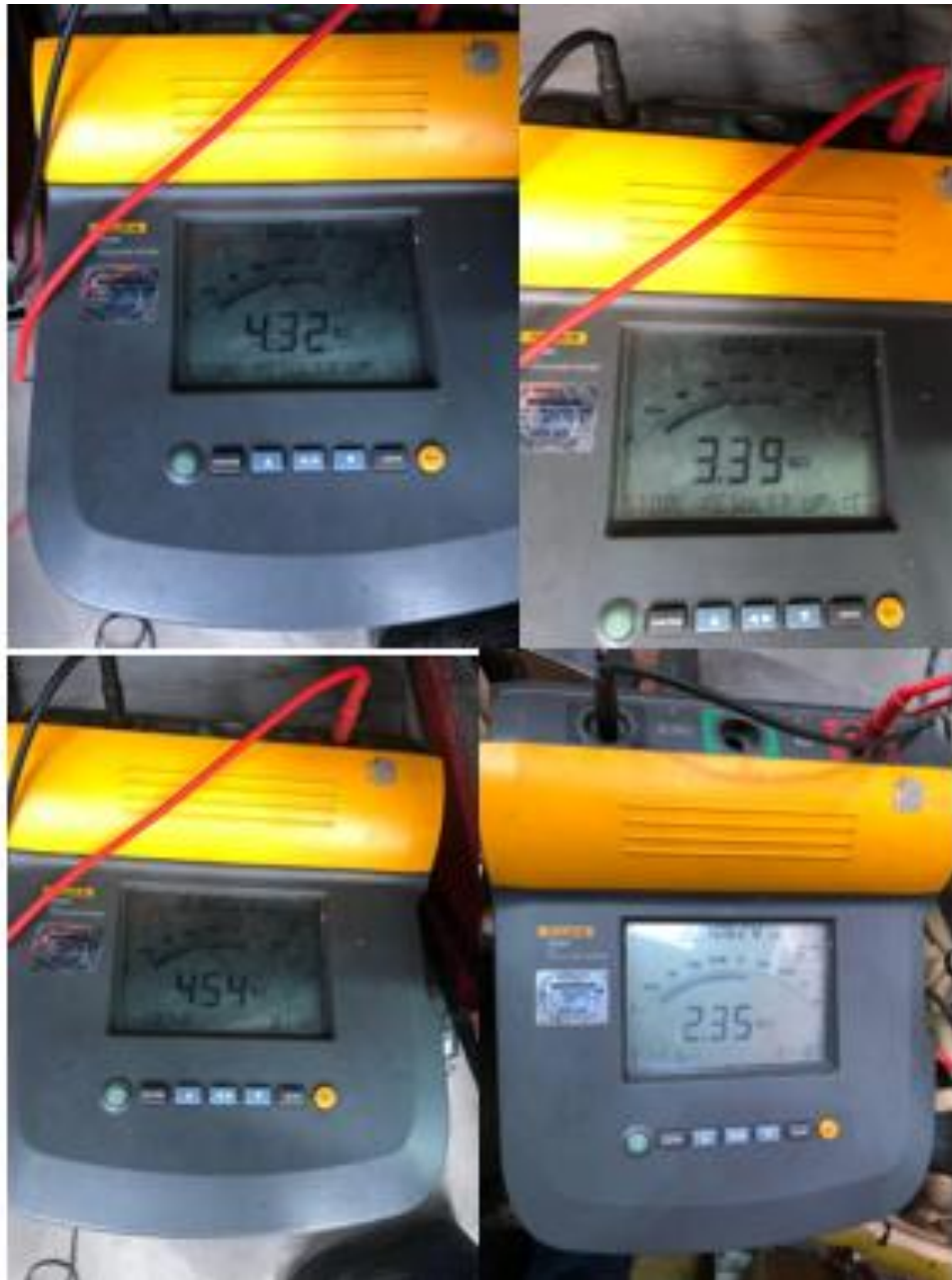
Ilustración 50::Prueba de Resistencia de Aislamiento 3247-1
