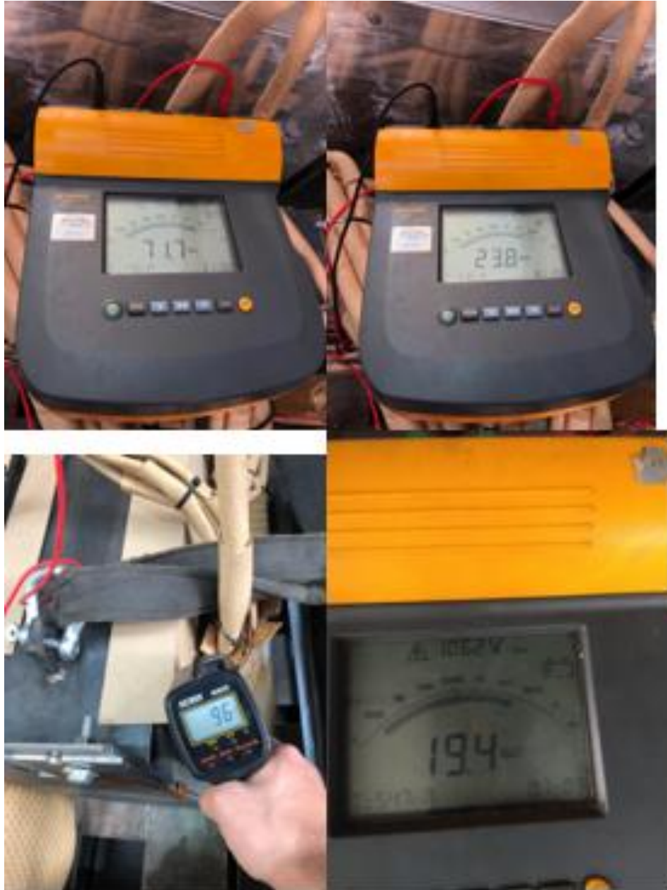
Ilustración 57:Ilustración 58:Prueba de Resistencia de Aislamiento 3536-1
