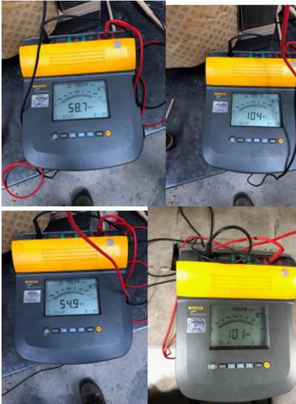
Ilustración 42: Prueba de Resistencia de Aislamiento 3542-1
