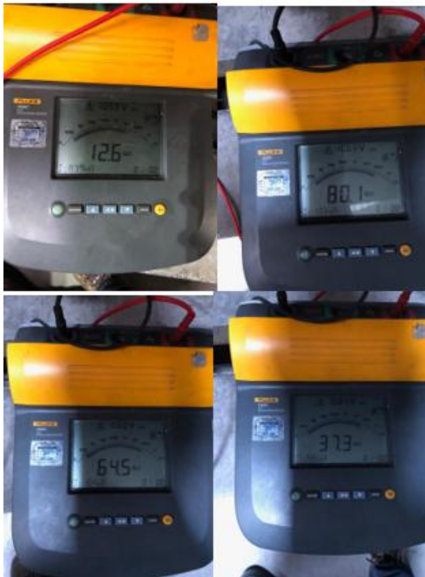
Ilustración 47: Prueba de Resistencia de Aislamiento 3542-1
