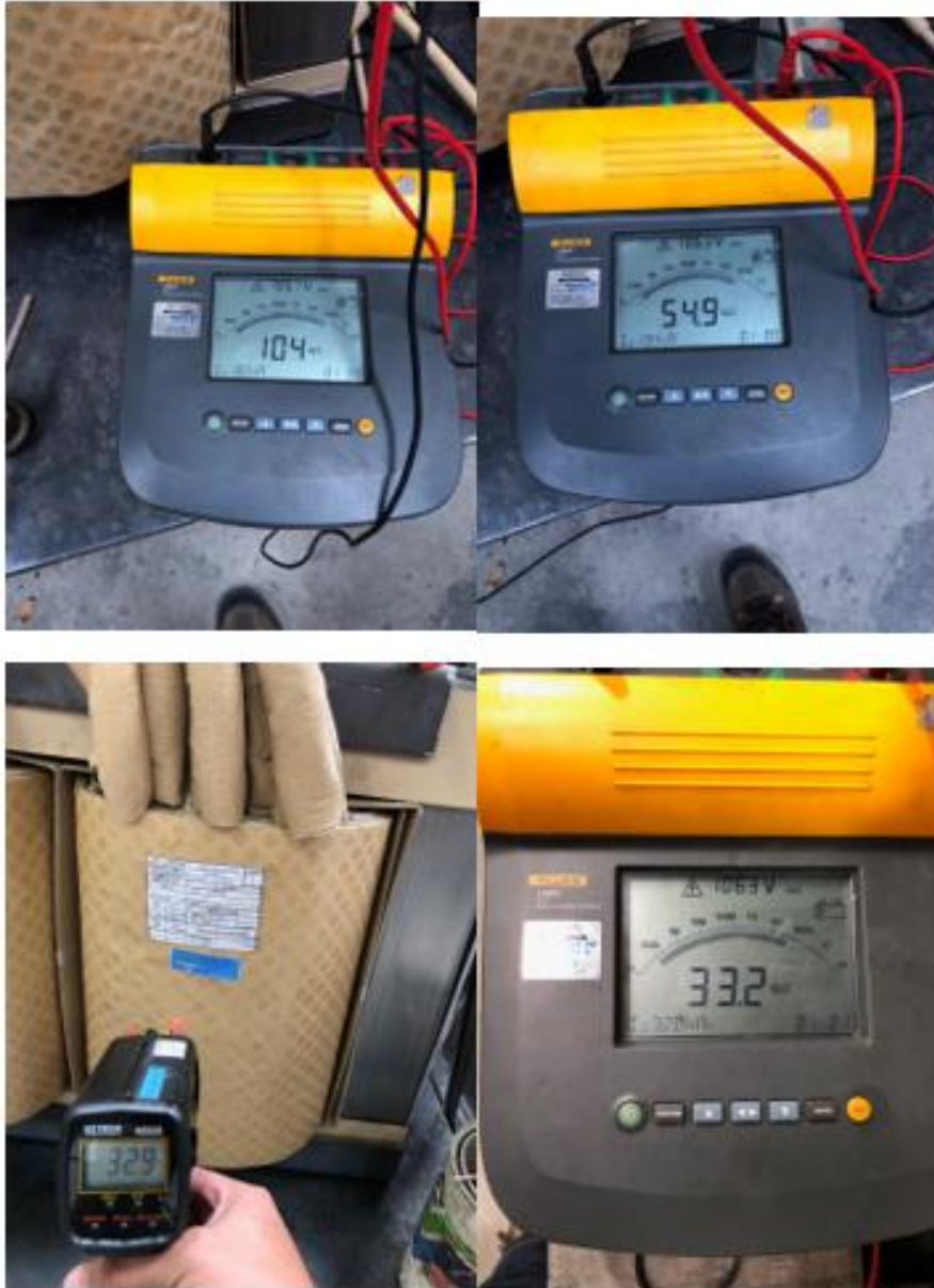
Ilustración 39: Prueba de Resistencia de Aislamiento 3542-1
