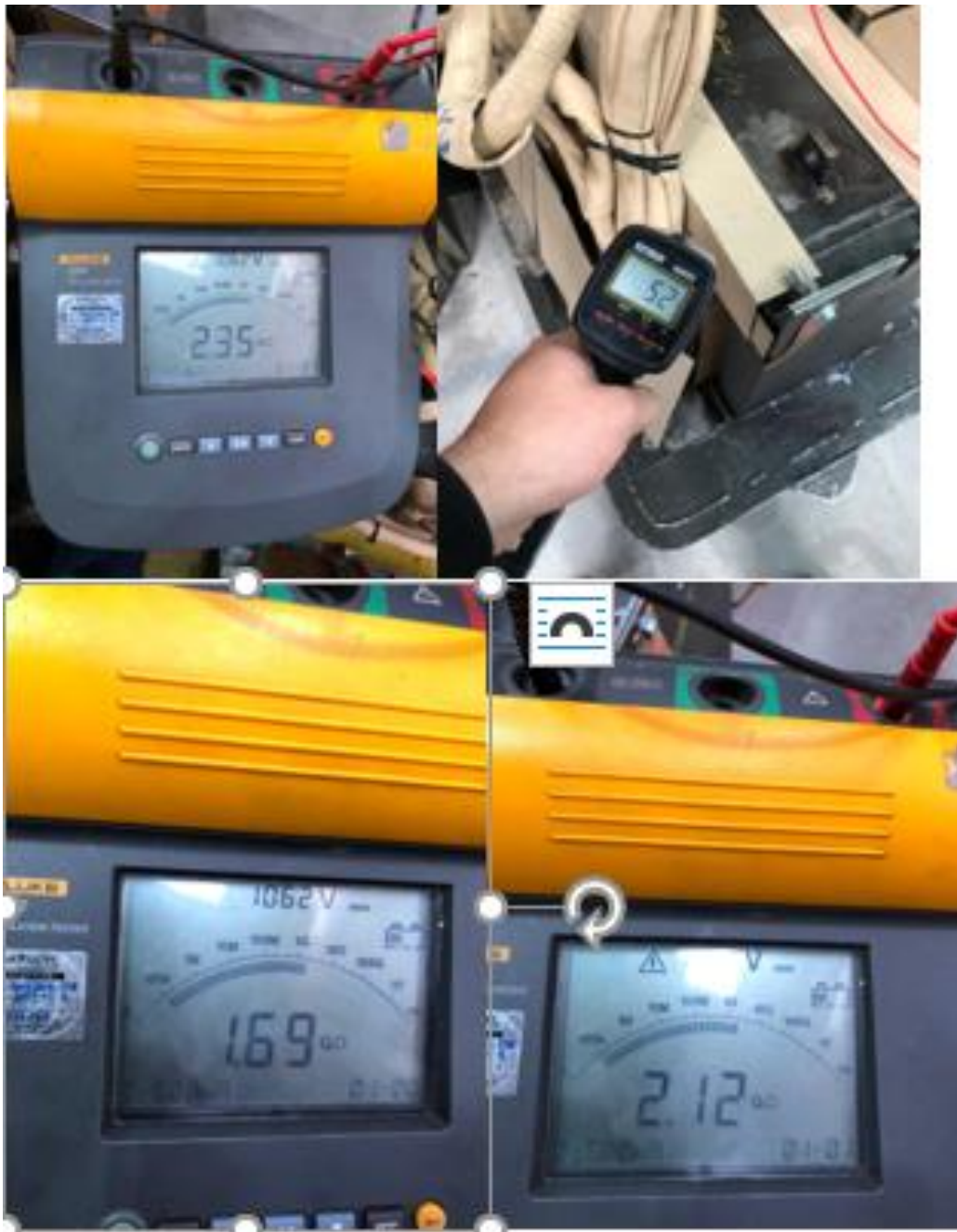
Ilustración 51: Prueba de Resistencia de Aislamiento 3247-1
