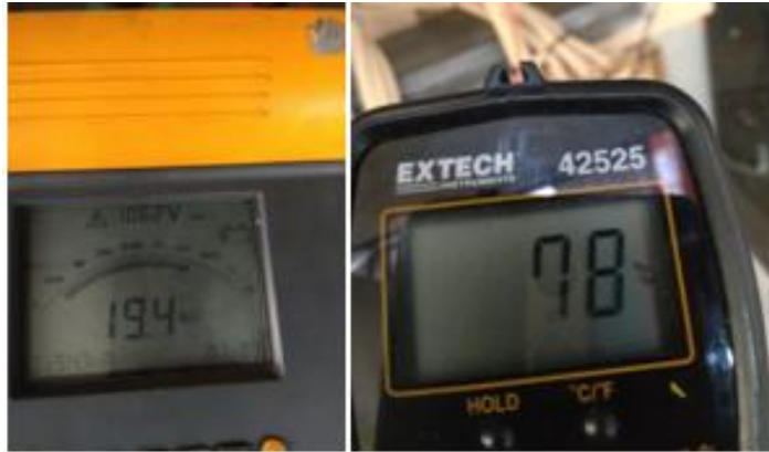
Ilustración 59: Ilustración 60: Prueba de Resistencia de Aislamiento 3536-1
