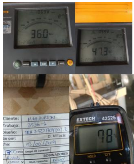
Ilustración 61: Prueba de Resistencia de Aislamiento 3536-1
