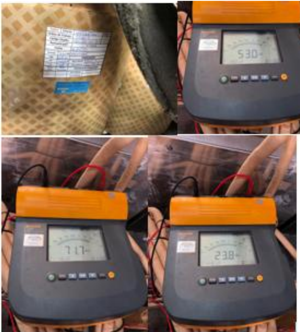
Ilustración 56::Prueba de Resistencia de Aislamiento 3536-1
