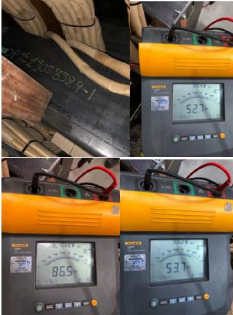
Ilustración 48: Prueba de Resistencia de Aislamiento 3529-1
