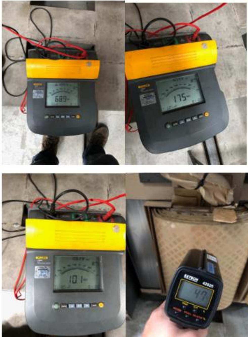
Ilustración 41: Prueba de Resistencia de Aislamiento 3542-1
