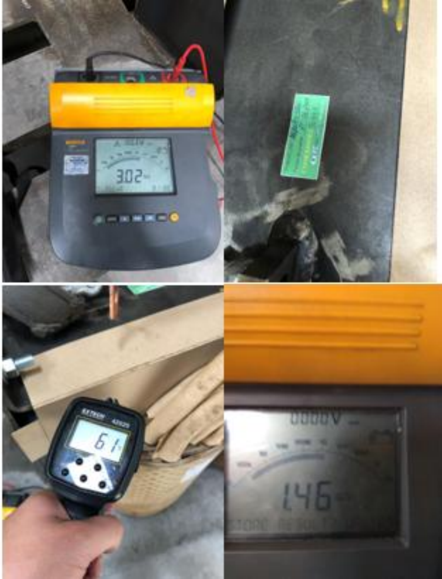
Ilustración 54: Prueba de Resistencia de Aislamiento 3247-1
