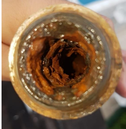
Ilustración 29: Tubería con corrosión interna
