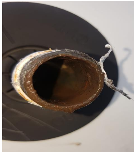
Ilustración 30: Tubería obstruida con sucio
