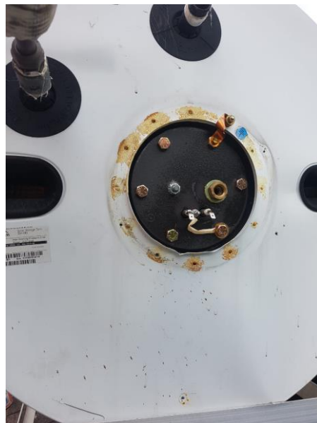
Ilustración 25: Corrosión en Acumulador
