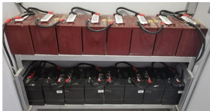
Ilustración 10. Banco de baterías.
