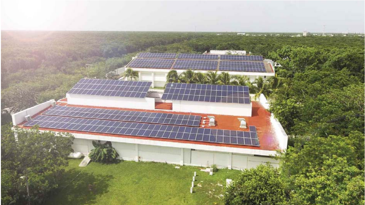
Ilustración 8. Instalación solar fotovoltaica sobre techo.
