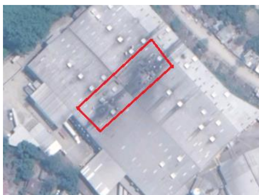
Ilustración 26. Mancha de aceite en el techo de la planta.
