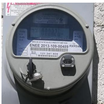
Ilustración 16. Medidor instalado por la ENEE.
