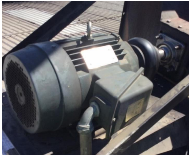
Ilustración 27. Motor expuesto a la intemperie.
