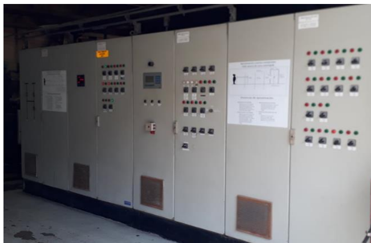
Ilustración 12. Panel de Distribución CAP
