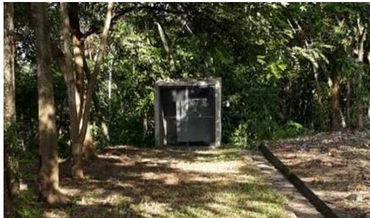
Ilustración 11. Transformador Seco del Edificio Administrativo
