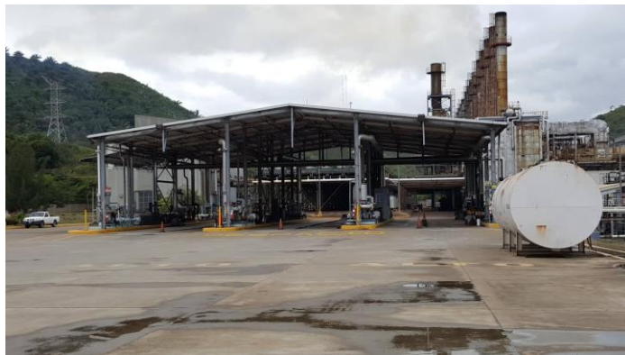
Ilustración 9. Inmueble del Rack de Descarga
