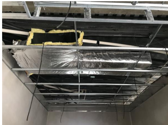
Ilustración 60: Ductos área de cocina
