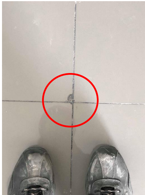
Ilustración 63. Cerámica dañada en sala
