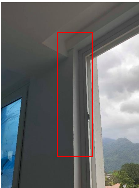
Ilustración 66. Daño en pared condominio 3DP
