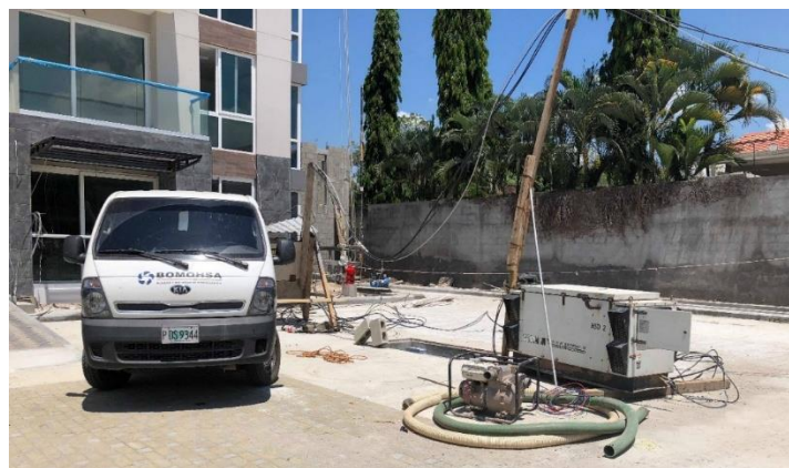
Ilustración 147. Pruebas de las bombas por parte de BOMOHSA
