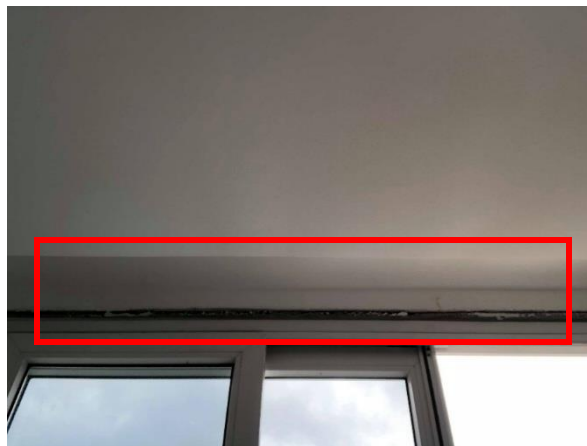
Ilustración 56. Daños en pared por colocado de tabla yeso
