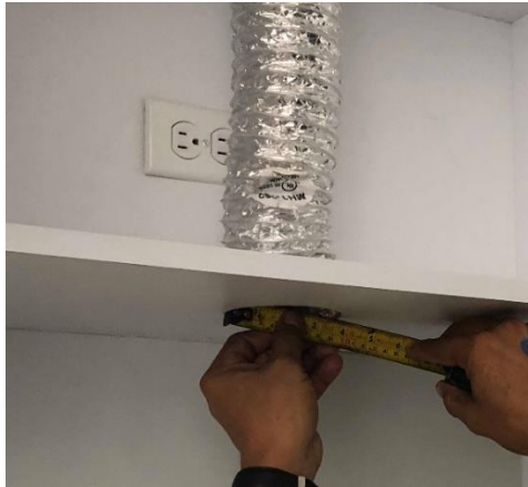
Ilustración 103. Perforación errónea con 3 pulgadas
