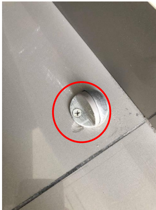
Ilustración 54. Daño en cerámica por colocado de tope
