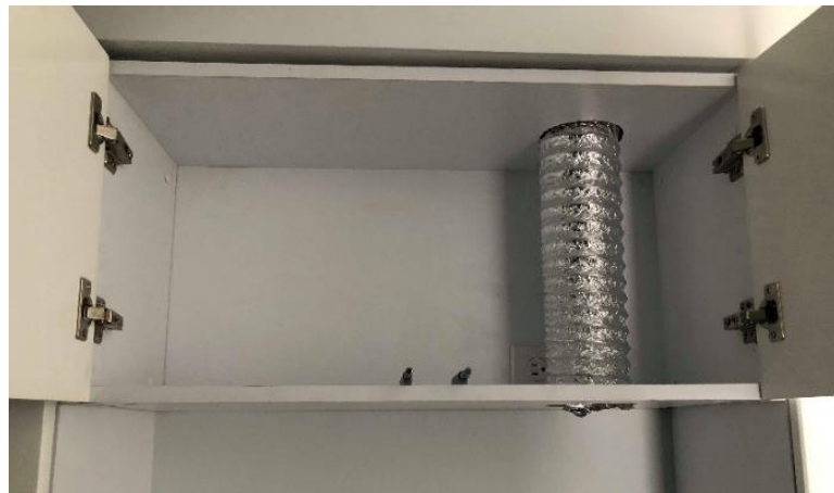
Ilustración 149. Error de perforación en mueble elevado
