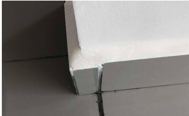
Ilustración 119. Mal acabado en zócalos
