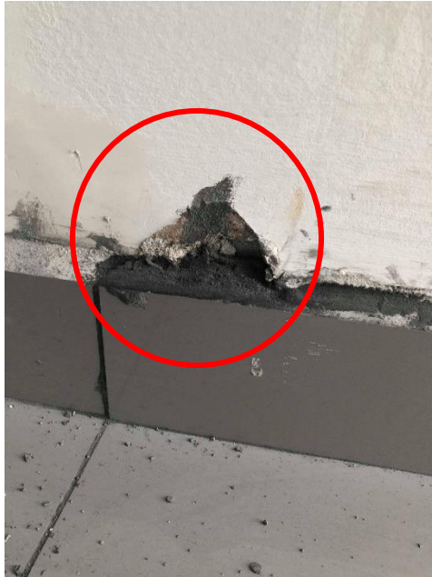
Ilustración 55. Daño de zócalo
