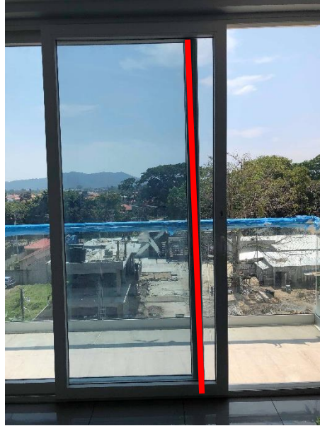
Ilustración 139. Desnivel en puerta corrediza
