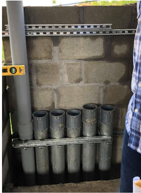
Ilustración 131. Ductos de instalaciones eléctricas
