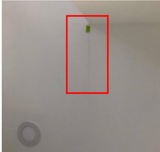
Ilustración 120. Fisura en cielo falso
