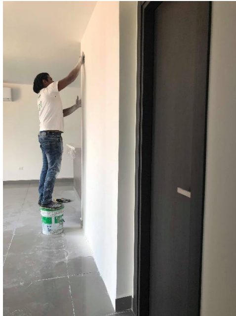
Ilustración 142. Pared corregida en condominio 4D
