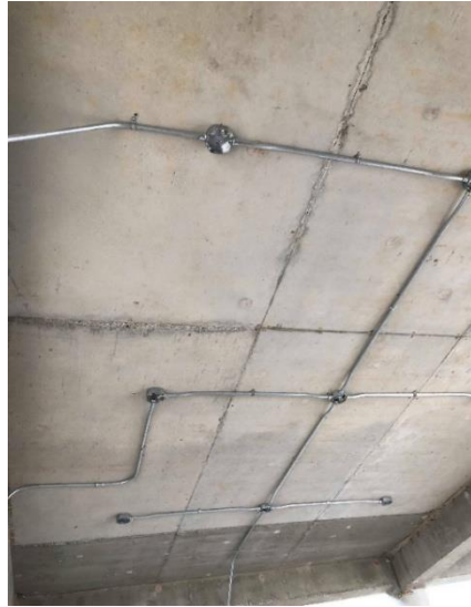
Ilustración 155. Cableado eléctrico en casa club
