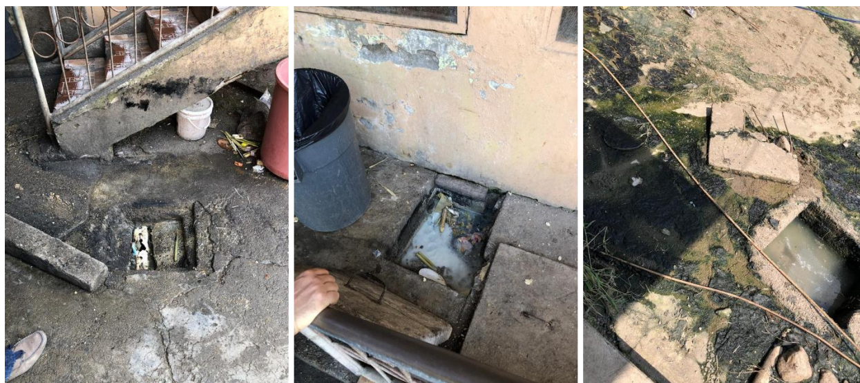
Ilustración 142 Estado Actual de las Cajas de Registro del Restaurante Tío Dolmo.
