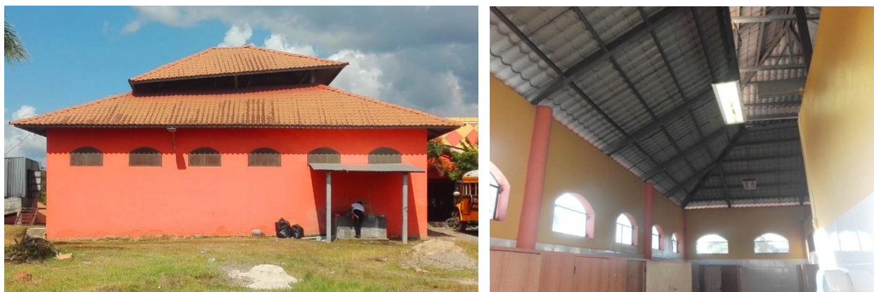
Ilustración 105 Registro Fotográfico de la Estructura del Monitor Colapsada.
