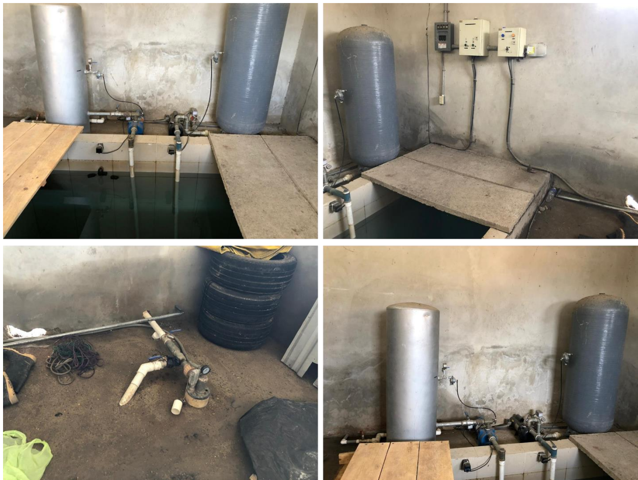
Ilustración 145 Registro Fotográfico de la Cisterna del Restaurante Tío Dolmo.
