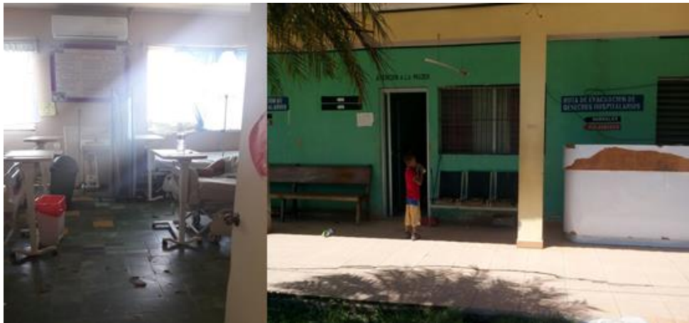
Ilustración 13. Piso en mal estado
