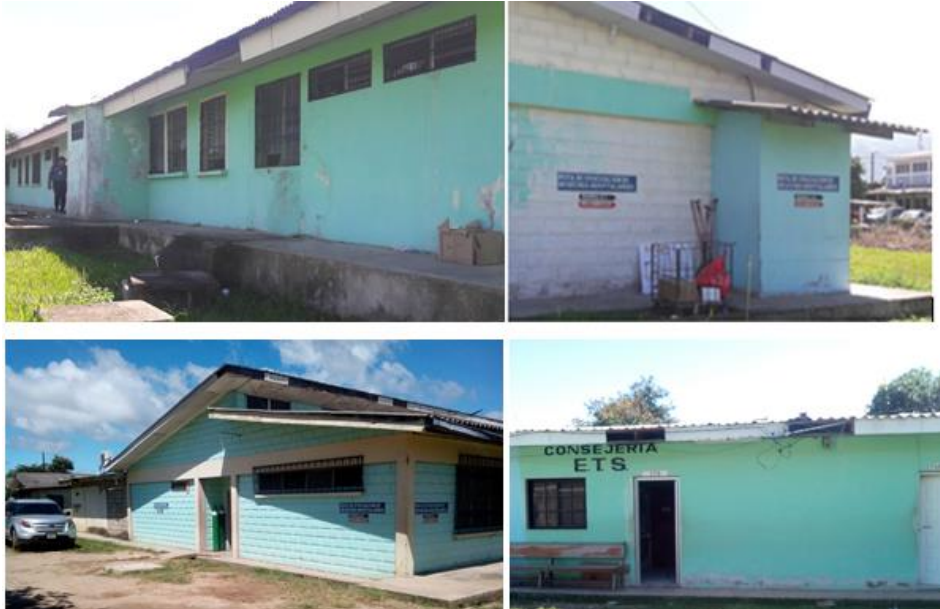
Ilustración 12. Tapa viento y cielo falso quebrados
