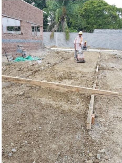
Ilustración 72: Armado y compactado de suelo para aceras entre módulos de autonomía económica y salud sexual.
