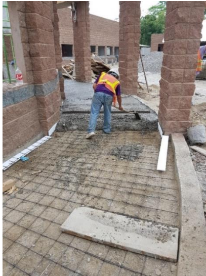
Ilustración 107: Fundición de firme de piso del módulo de recepción en la parte externa.
