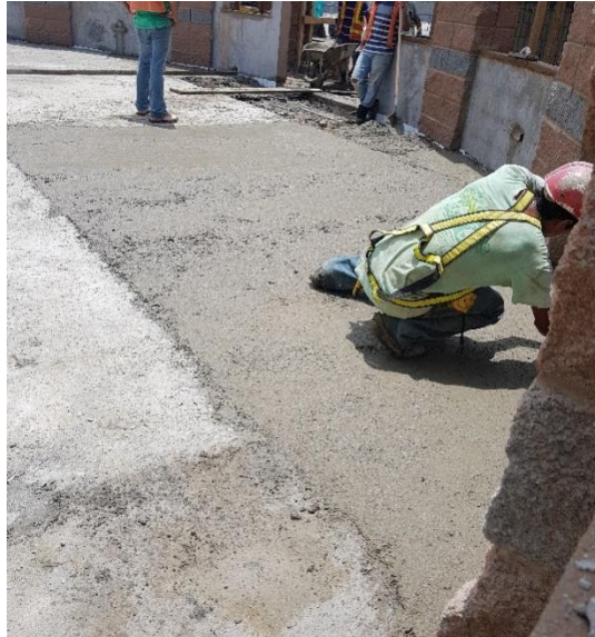
Ilustración 78:Fundición de firme de piso en el área principal del módulo de recepción.
