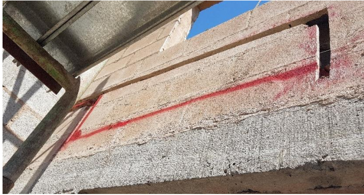
Ilustración 52: Marcado y ranurado para nueva instalación de tubería para alarma contra incendio para módulo de salud sexual.
