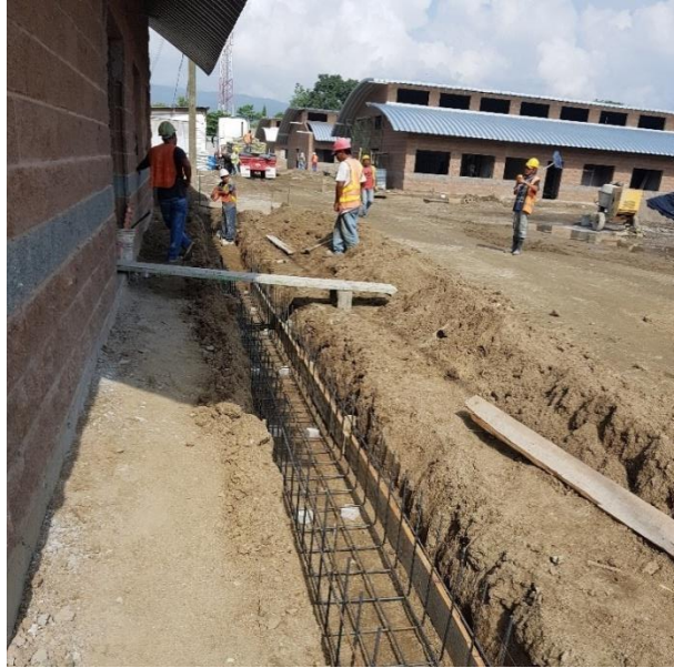
Ilustración 90: Armado y colocación de hierro para canal recolector de aguas lluvias en módulo de atención a los adolescentes.
