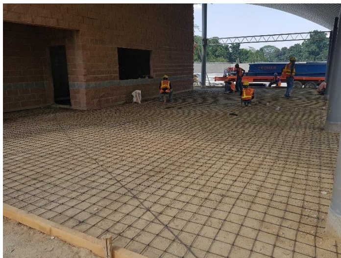
Ilustración 39: Armado de hierro para firme de piso en el área de comedor módulo de cafetería. Fuente: Sandoval, E. (2018).
