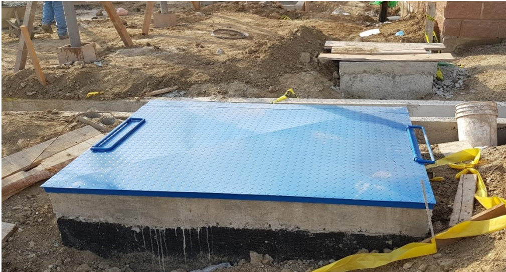
Ilustración 154: Tapaderas metálicas 1.20 x 1.20 mts para cajas eléctricas.
