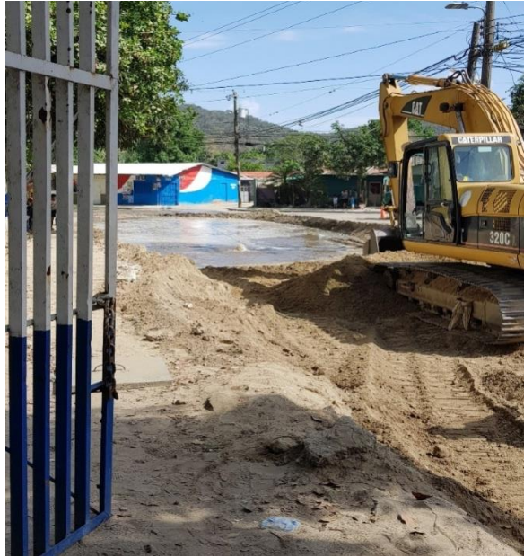
Ilustración 101: Problemas en acceso principal al proyecto por ruptura de tubería.
