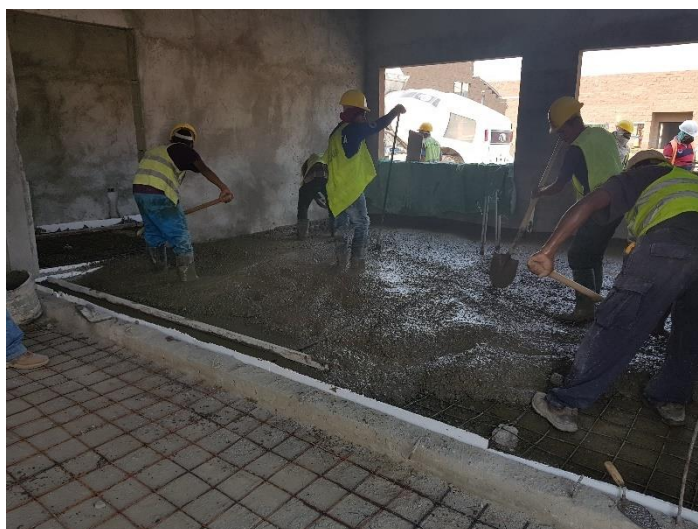
Ilustración 59: Fundición de firme de piso en módulo de autonomía económica. Fuente: Sandoval, E. (2018).
