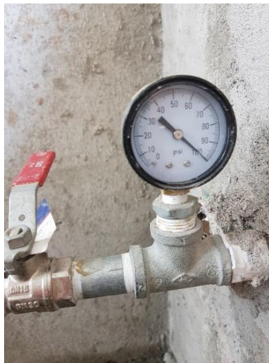
Ilustración 63: Instalación de manómetro para pruebas hidrostáticas en áreas de baños en módulo de autonomía económica.
