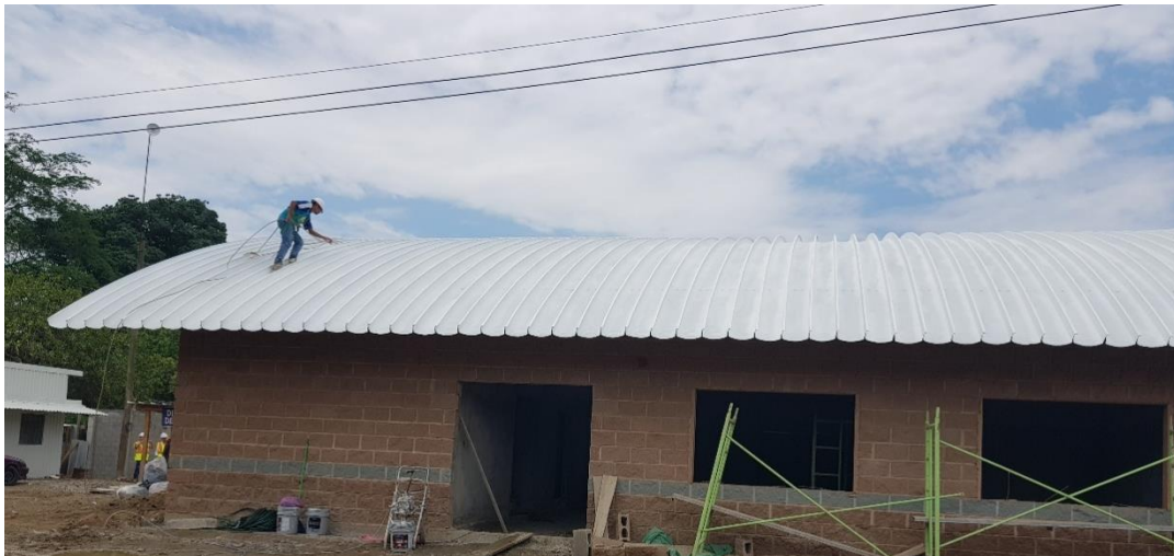
Ilustración 75: Aplicación de pintura impermeabilizante y térmica en techos curvos módulo atención a los adolescentes.
