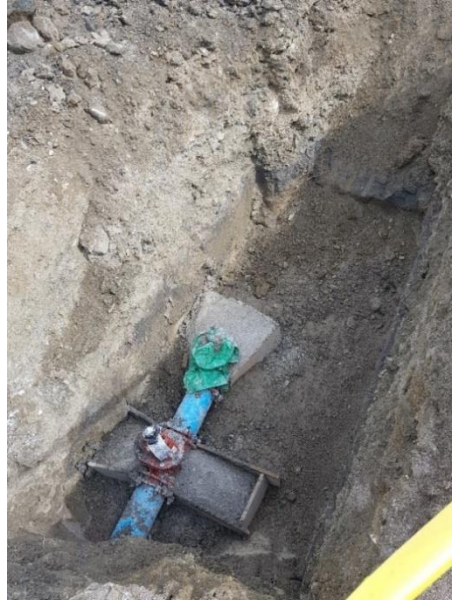
Ilustración 130: Excavación e instalación de tubería contra incendios y fundición de dado trapezoidal para atraque.
