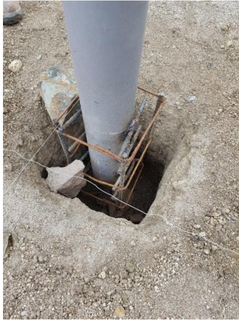
Ilustración 121: Excavación de 0.50 cm y armado de hierro con soldadura con varilla #3 para el pedestal.
