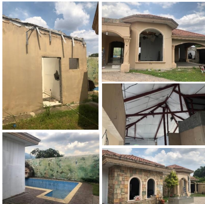
Ilustración 26 Estado Actual de vivienda para Restaurante Kim Chon
