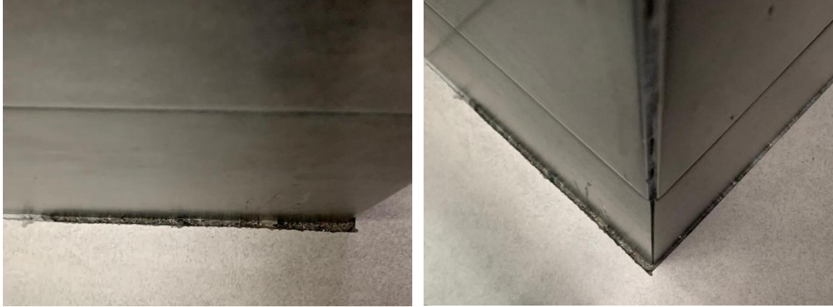
Ilustración 61. Falta de fragua en unión de porcelanato a columna
