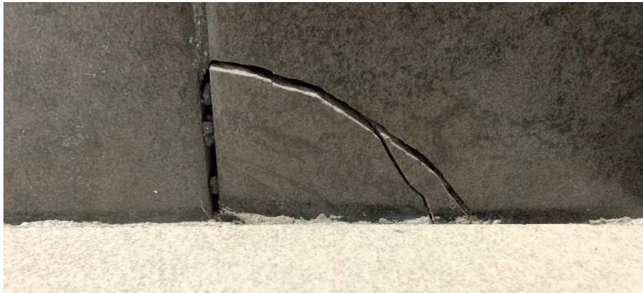
Ilustración 62. Fisura en porcelanato de columna
