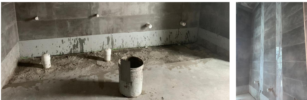
Ilustración 72. Tuberías hidrosanitarias baño caballeros Torre 3
