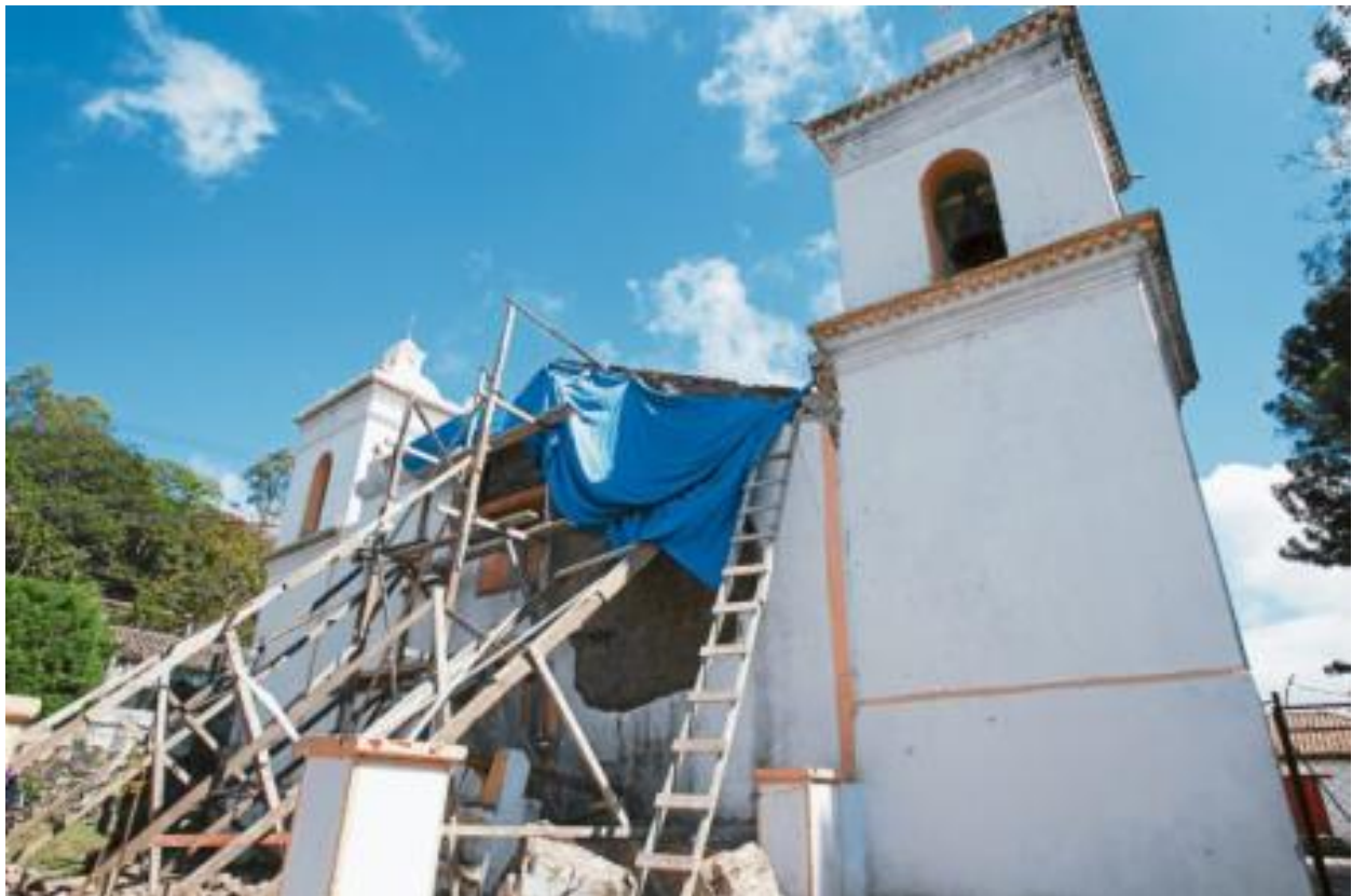
Ilustración 40 Fachada de la iglesia dañada en 2015 (Calix, 2014)
