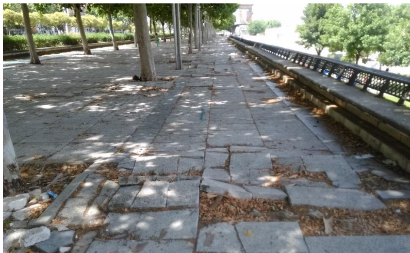
Ilustración 20 Senda de Ciclovía Dañada por la Vegetación.
