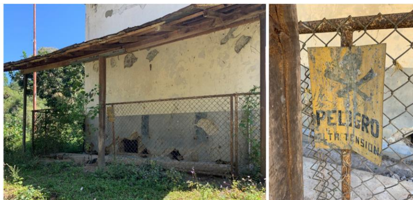
Ilustración 84. Techo que cubría donde se encontraban los transformadores. Nótese la advertencia de "Peligro. Alta tensión".
