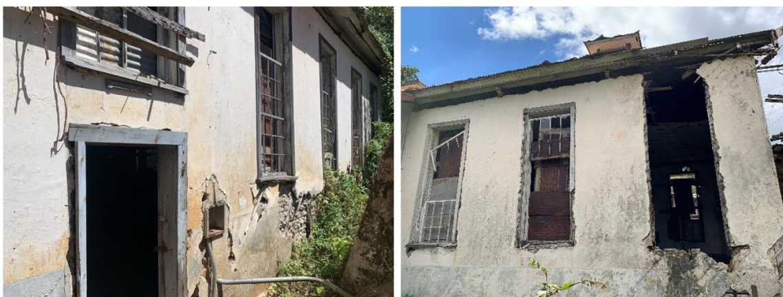
Ilustración 16. La Antigua Planta Hidroeléctrica en condición de desplome y con problemas de humedad o destrucción, año 2020.
