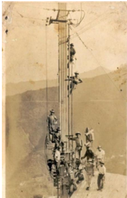
Ilustración 63. La primera torre de energía de la central hidroeléctrica. Nótese la cantidad de trabajadores eléctricos encargados de esas labores.
