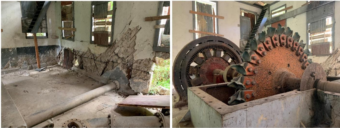
Ilustración 17. Pared de La Antigua Planta Hidroeléctrica con problemas estructurales y turbinas dañadas a través de los años, año 2020.
