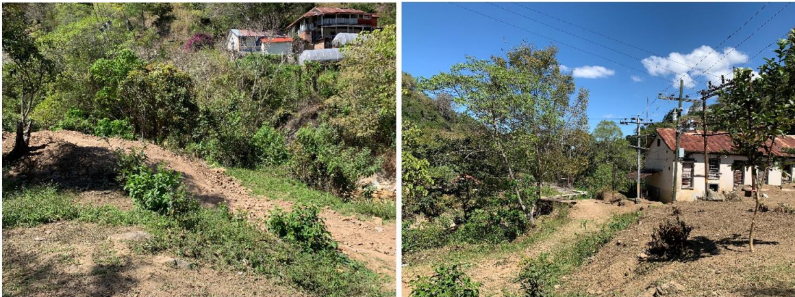
Ilustración 19. Sendero hacia La Antigua Planta de Energía Hidroeléctrica. Nótese las malas condiciones en que se encuentra; no es un acceso universal y podría ocasionar lesiones o caídas.
