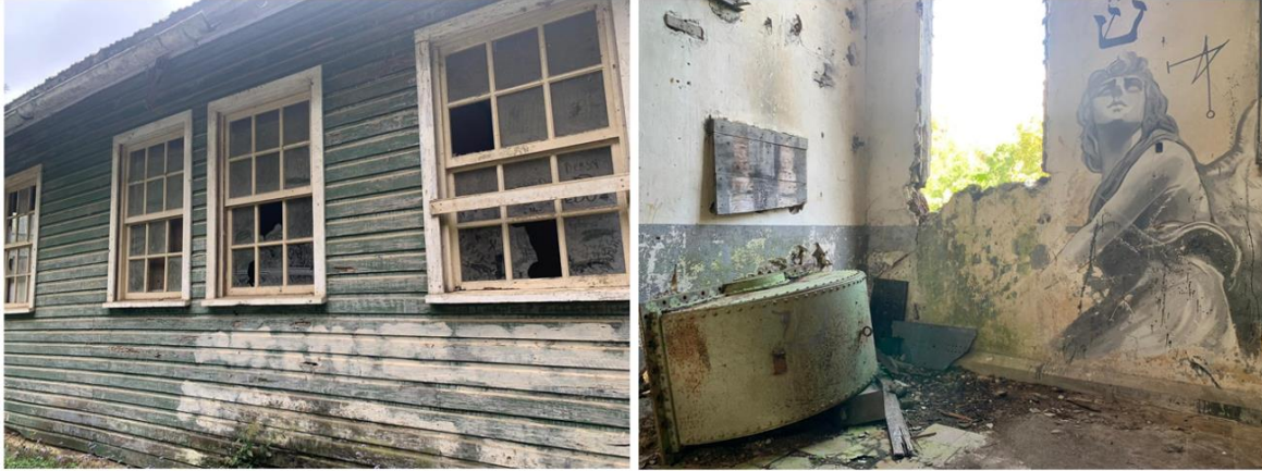
Ilustración 14. (Izq.) Vidrios rotos de las ventanas de las antiguas residencias. (Der.) Murales-Grafiti en las paredes de la Antigua Planta de Energía Hidroeléctrica.
