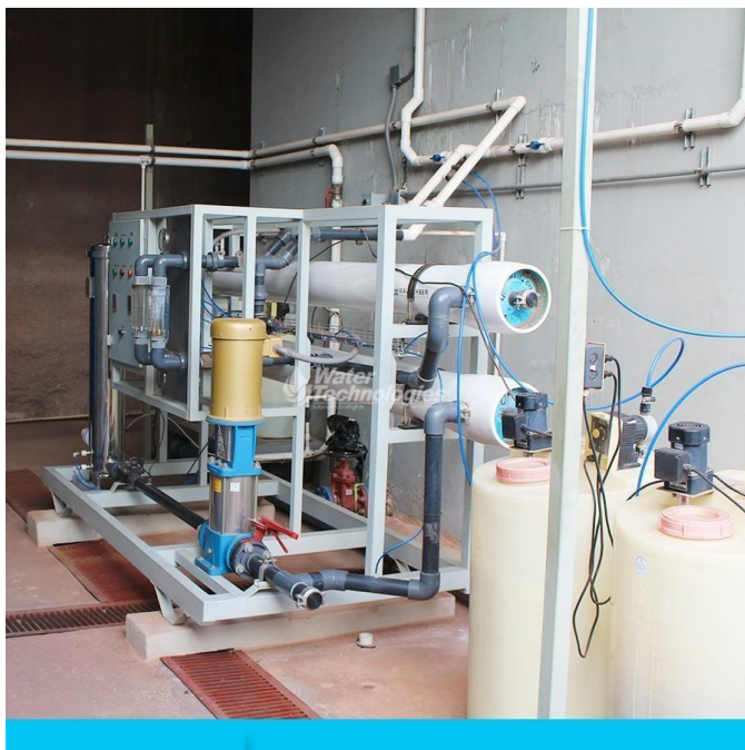
Anexo #4 Proyecto Industrial pequeño. Osmosis inversa con 2 membranas.
