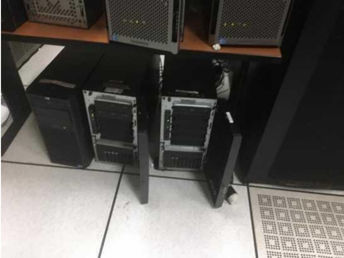
Ilustración 11. Servidores en mal estado.
