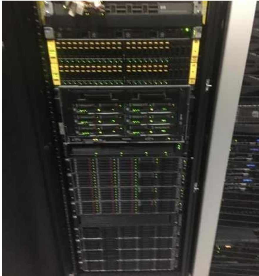
Ilustración 12. Gabinete abierto y sin identificación.
