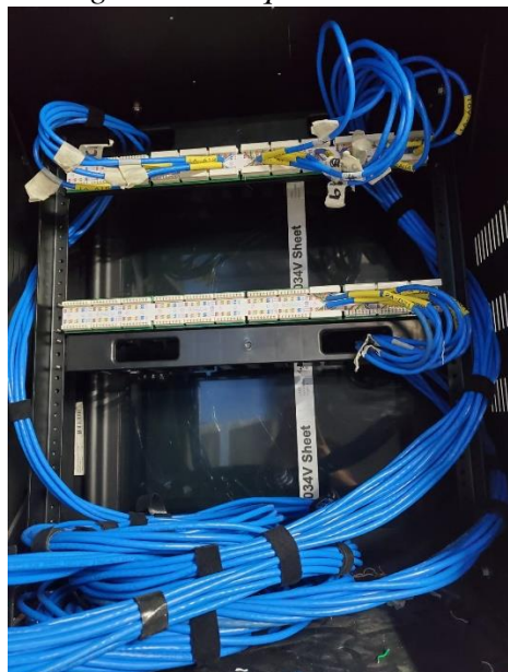
Figura 8: Etiquetado de rack inferior.
